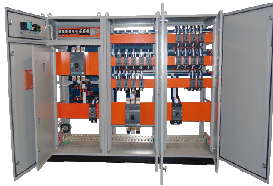
Figura 3.6 - Interior de um Quadro Elétrico.
