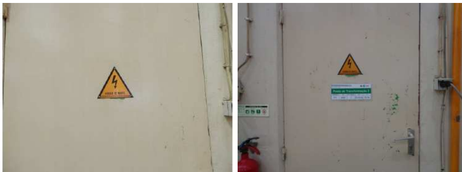
Figura 4.7 - Correção da não conformidade de falta de identificação do PT2
