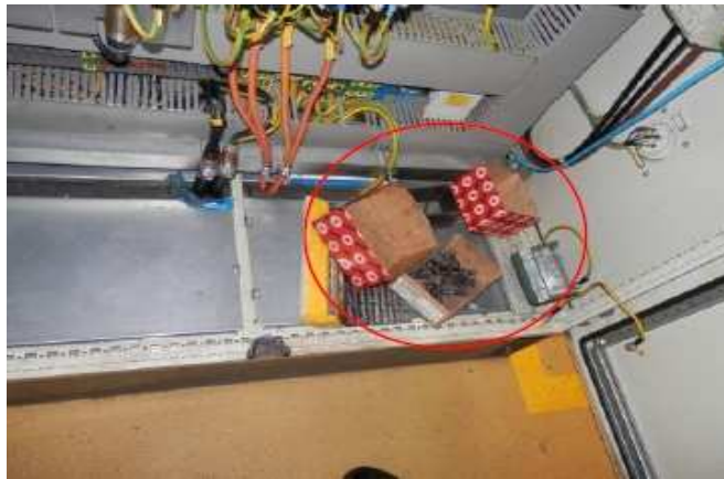
Figura 4.15 - Elementos estranhos ao quadro Elétrico presentes no seu interior
