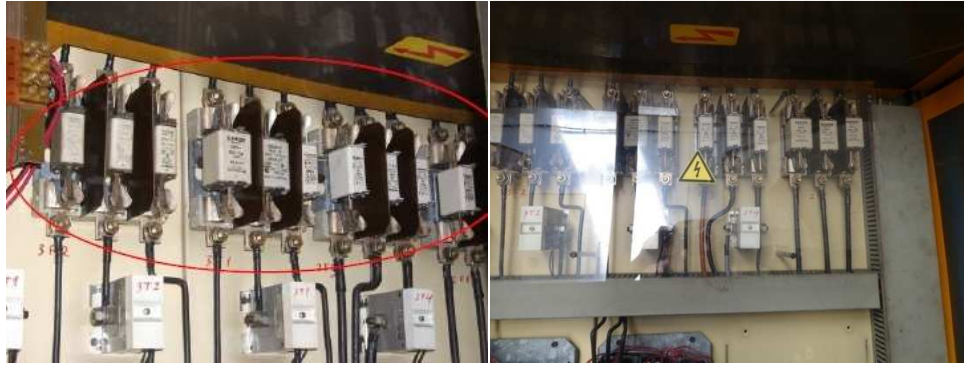
Figura 4.11 - Colocação de barreira isolante, auto extingüível, para proteção CD
