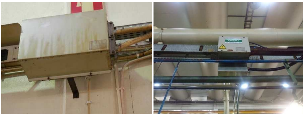
Figura 4.10 - Correção da falta de identificação nas “CANALIS”
