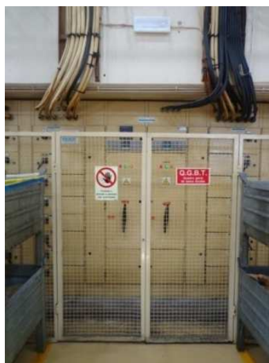
Figura 4.3 - QGBT do edifício 2 da Schaeffler Portugal S.A.
