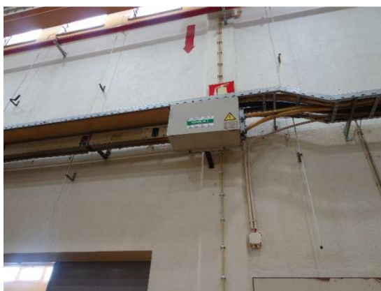
Figura 4.6 - Caminhos de cabos em esteira e "CANALIS"
