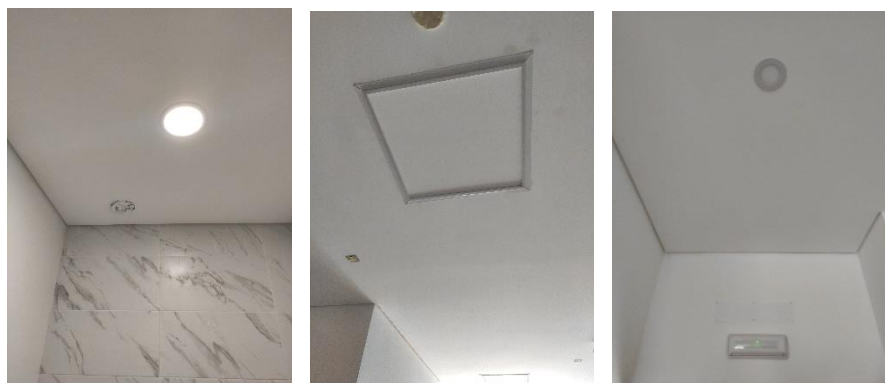
Figura 3.10 - Representação de algumas lâmpadas e luminárias do tipo LED existentes no edifício.
