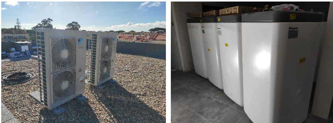
Figura 3.9 - Sistema de produção de AQS: bombas de calor (lado esquerdo) e depósitos de 500L (lado direito).
