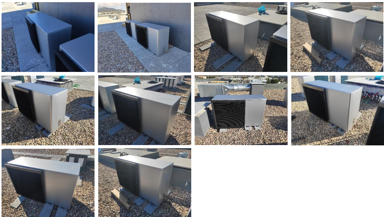
Figura 3.8 – Sistema de climatização e ventilação: unidades exteriores do tipo bomba de calor.
