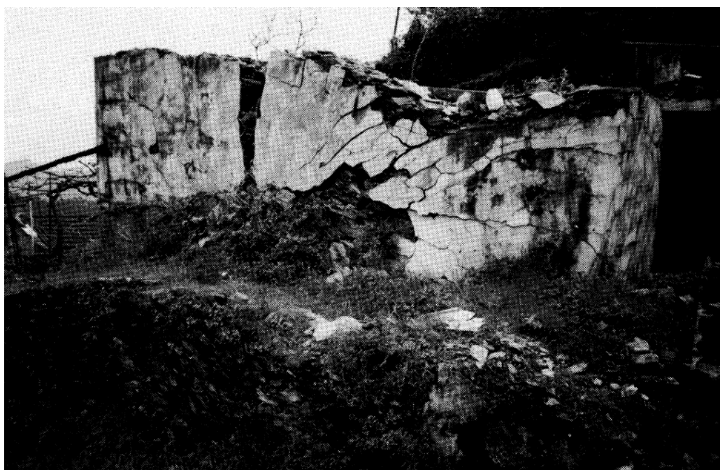
Figura 13 – Efeitos de uma descontinuidade (“Quebra Vertical”) numa habitação na área de Germunde. (Silva & Chaminé, 1993)
