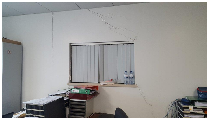
Figura 58 – Fendilhação de parede interior, zona de escritórios, no 1.º piso
