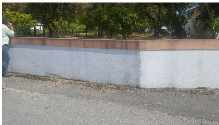
Figura 55 – Estado atual do muro, na zona em que ruiu
