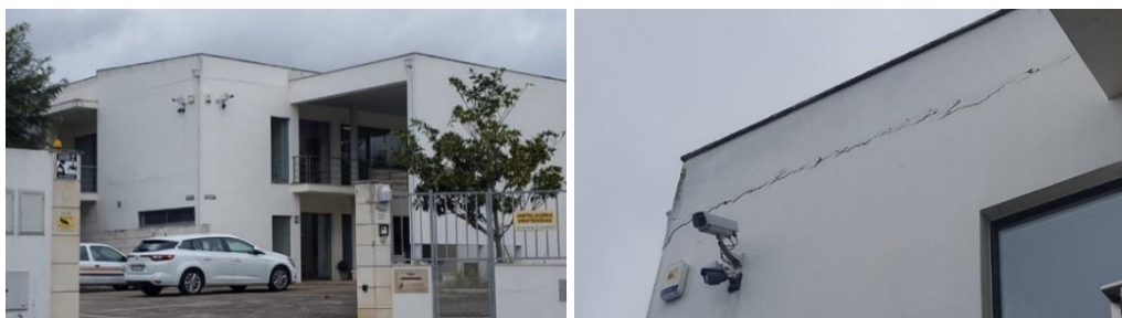
Figura 56 e Figura 57 – Fendilhação exterior na fachada frontal e lateral esquerdo, estendendo-se a partir da zona do pilar
