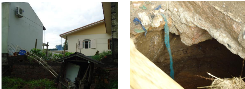
Figura 7 e Figura 8 - Danos em edifício causados por subsidência de antiga mina de carvão na localidade do bairro Rio Maina, Criciúma/SC. (Baccin, 2011)
