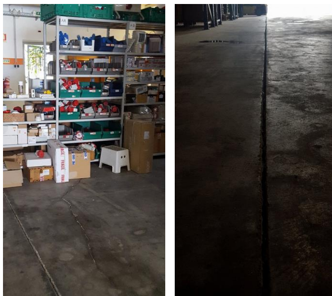
Figura 59 e Figura 60– Pavimento do armazém, com junta de dilatação, apresentando abertura excessiva, com fendilhação e assentamento do pavimento em zona de proximidade à mesma.
