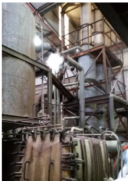
Figura 8 - Torre de destilação
