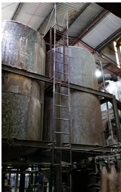
Figura 7 - Tanques de decantação
