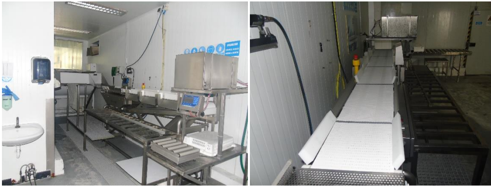
Figura 10- Máquina calibradora na sala de abate e embalagem (Fonte: própria)
