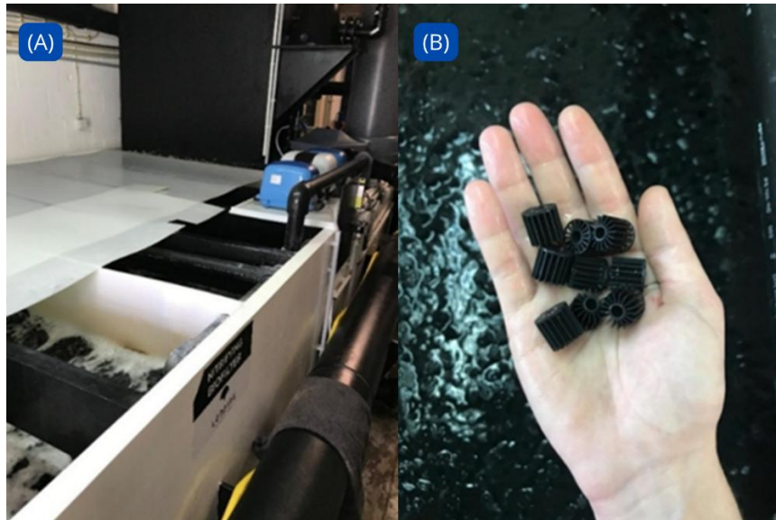
Figura 15: Filtração biológica com (A) biofiltro MBBR e (B) media utilizada.
