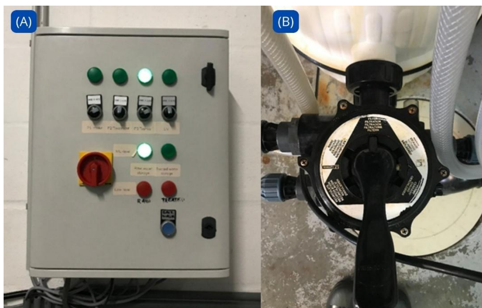
Figura 23: Procedimento de backwash do filtro de areia (A) Painel de controlo do sistema de filtração (B) Válvula multívia.
