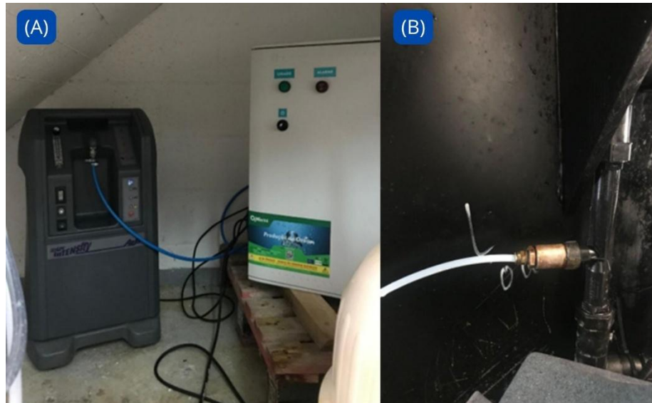
Figura 16: Componentes essenciais para ozonizar a água no local com (A) concentrador de ozono e gerador de oxigénio (B) entrada de ozono pelo venturi.
