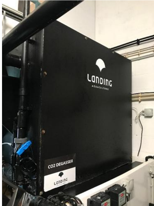
Figura 17: Desgaseificador, situado na parte final do biofiltro
