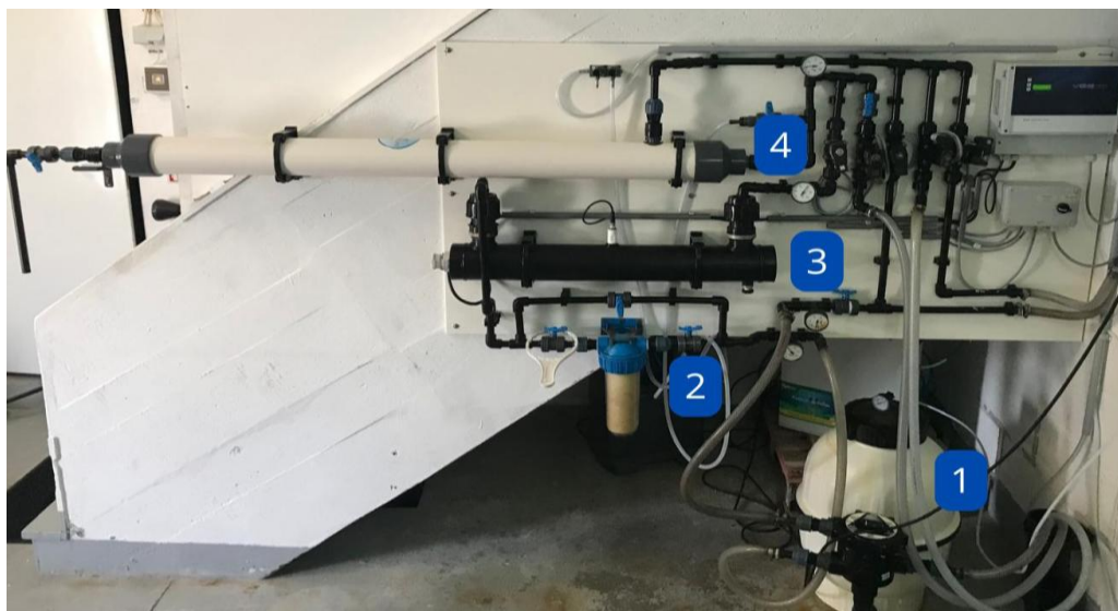
Figura 10: Sistema de filtração da entrada de água com (n° 1) Filtro de areia, (n° 2) Filtro de cartucho, (n° 3) Lâmpada ultravioleta e (n° 4) Membrana ultrafiltração.
