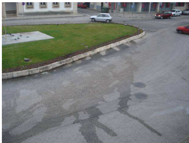
Figura 42: Exemplo de escorrências sobre o anel de circulação, resultantes da rega da ilha central Março 2012
