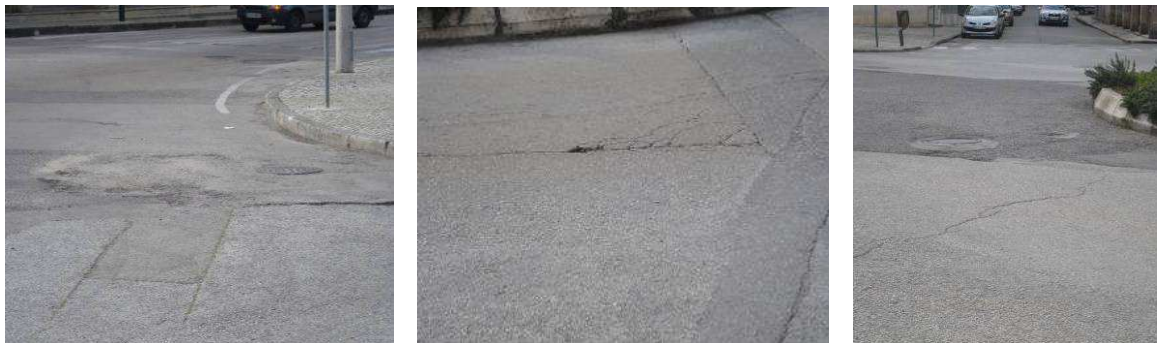
Figura 39: Exemplos de deficiências no pavimento do anel de circulação Abril 2013
