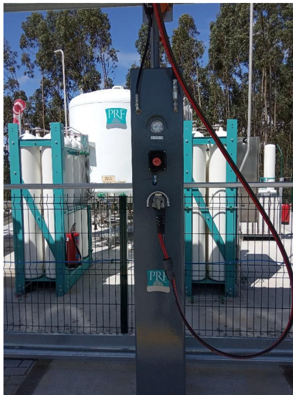
Figura 52 – Unidade de enchimento de GNC (retirado de (28))
