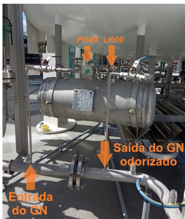
Figura 48 – Reservatório de THT e sua instrumentação (retirado de (28))
