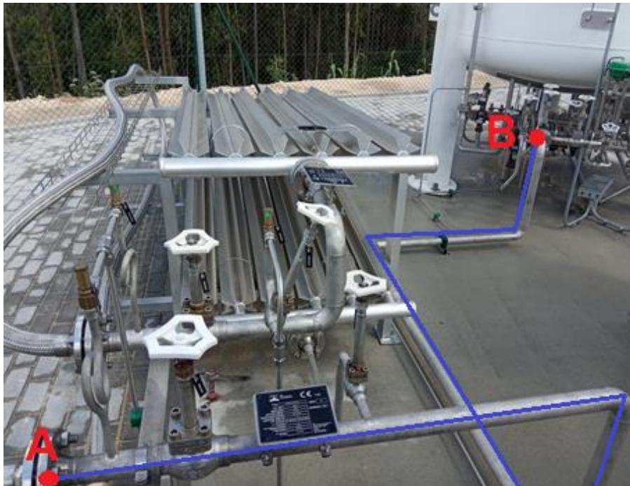
Figura 41 – Tubagem de descarga implementada (retirado de (28))
