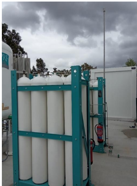
Figura 50 – Baterias de armazenamento de GNC (retirado de (28))
