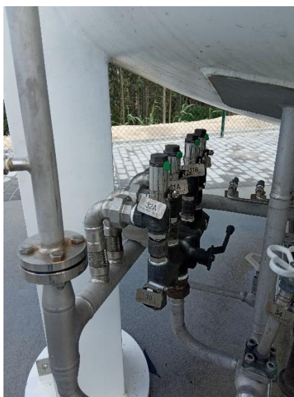
Figura 44 – Válvulas de segurança do reservatório de GNL (retirado de (28))
