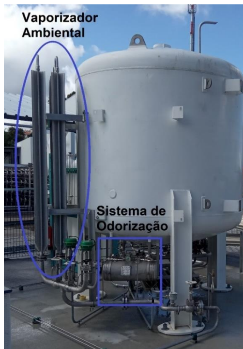
Figura 46 – Equipamentos integrantes do reservatório de GNL de baixa capacidade (retirado de (28))
