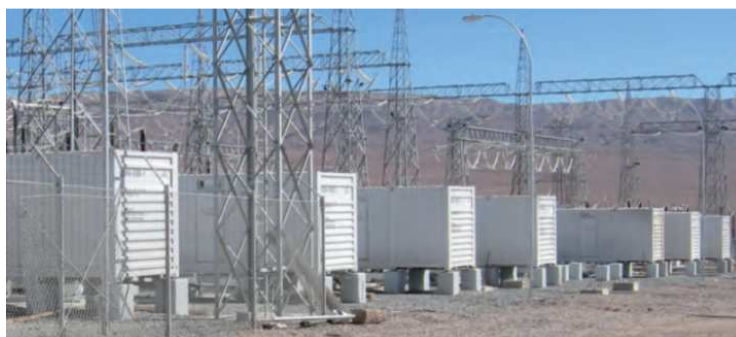
Figura 17 – Subestação com suporte de armazenamento de energia com baterias de íões de lítio (12MW) [21]
