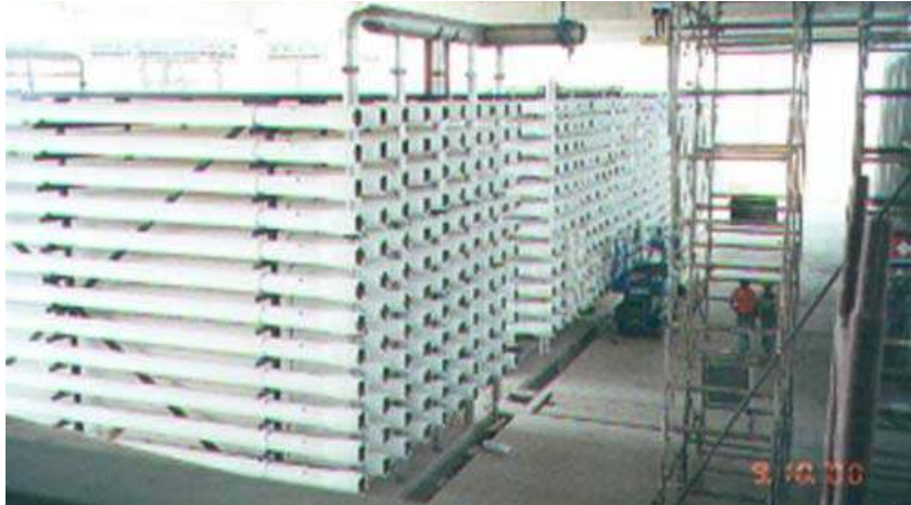
Figura 3.14 - Unidades de RO de uma instalação de dessalinização de água do mar (IDAM) (Larnaca, Chipre). Fonte: www.ide-tech.com
