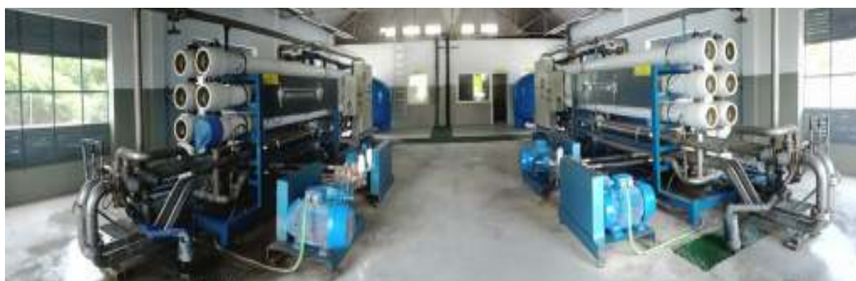
Figura 4.23 - Unidades de RO (com capacidade individual de 500 m 3 /dia), e ERDs RO KINETIC K200 no IDAM da APN (Santo Antão). Fonte: Águas de Porto Novo.
