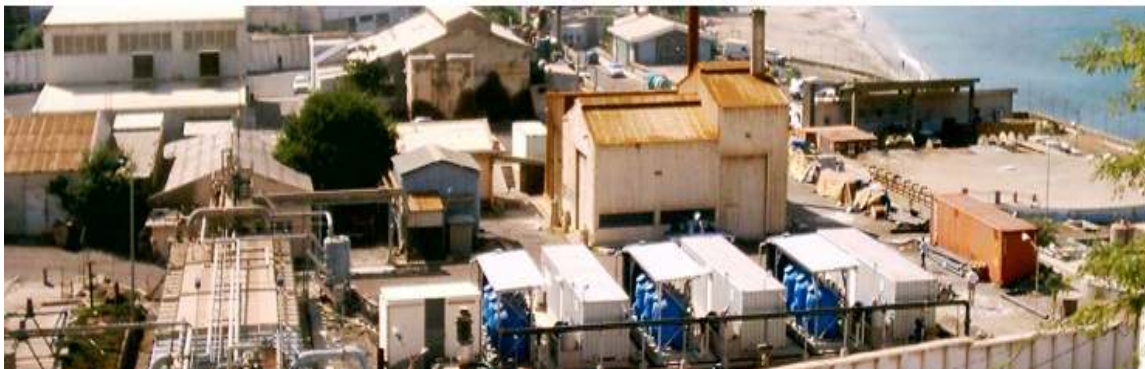
Figura 4.16 – Instalações de ELECTRA localizada no Matiota, ilha de São Vicente. Fonte: ELECTRA 26
