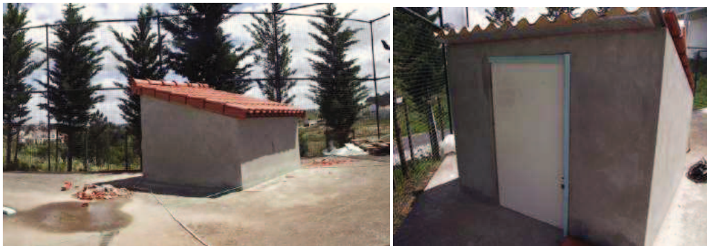
Figura 60 – Célula de teste concluída.
