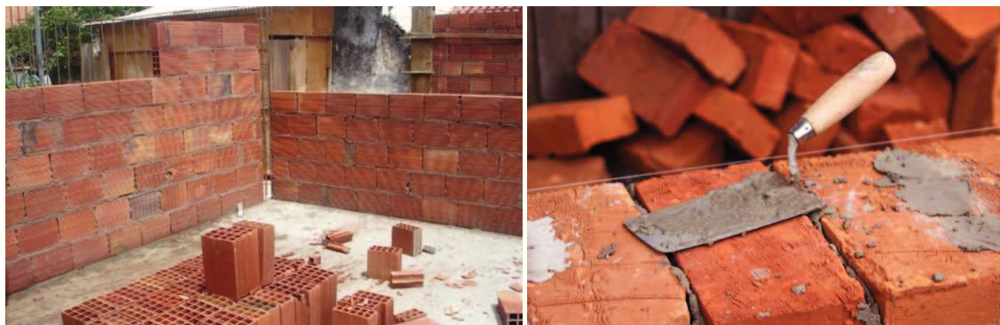
Figura 25 – Construção de uma parede simples de alvenaria com tijolo cerâmico de furação horizontal e maciço respectivamente.
