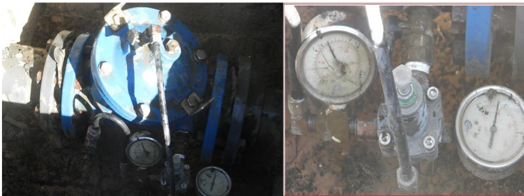
Figura 14. Válvula Redutora de Pressão, colocada a jusante do reservatório N°1 e a montante da rede de distribuição de água. (Fonte: Autor)
