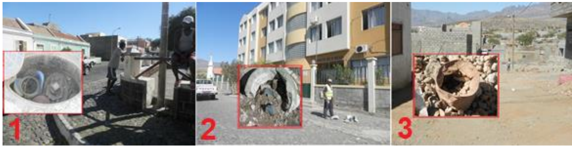
Figura 17. Boca-de-incêndio na zona do Armazém (1); Boca-de-incêndio na zona de Chã de Itália (2); Boca-de-incêndio na zona de Chã de Matinho (3) (Fonte: Autor)
