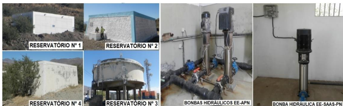
Figura 12. Reservatórios de distribuição de água e bombas hidráulicas. (Fonte: Autor)
