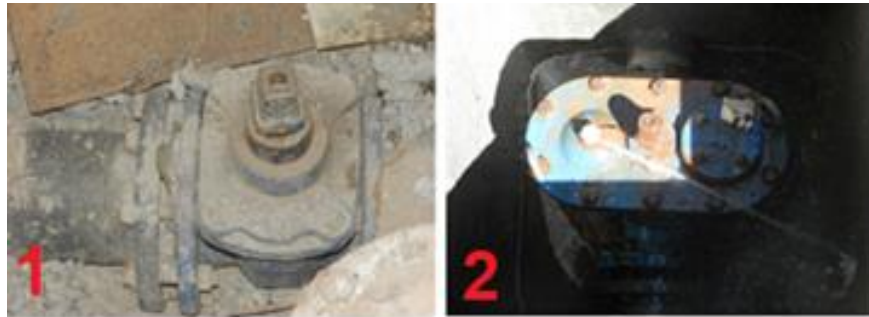
Figura 15. Válvula de seccionamento (1); Ventosa (2) (Fonte: Autor)
