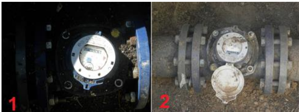
Figura 18. Contador mecânico à saída do reservatório N°1(1); Contador no ramal de ligação do Hotel Art Risort (2). (Fonte: Autor)
