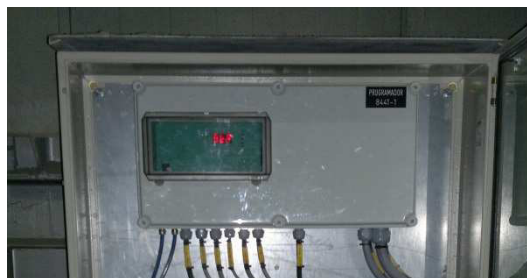
Figura 3.7 – Programadores dos Filtros de mangas com medição de \Delta p
