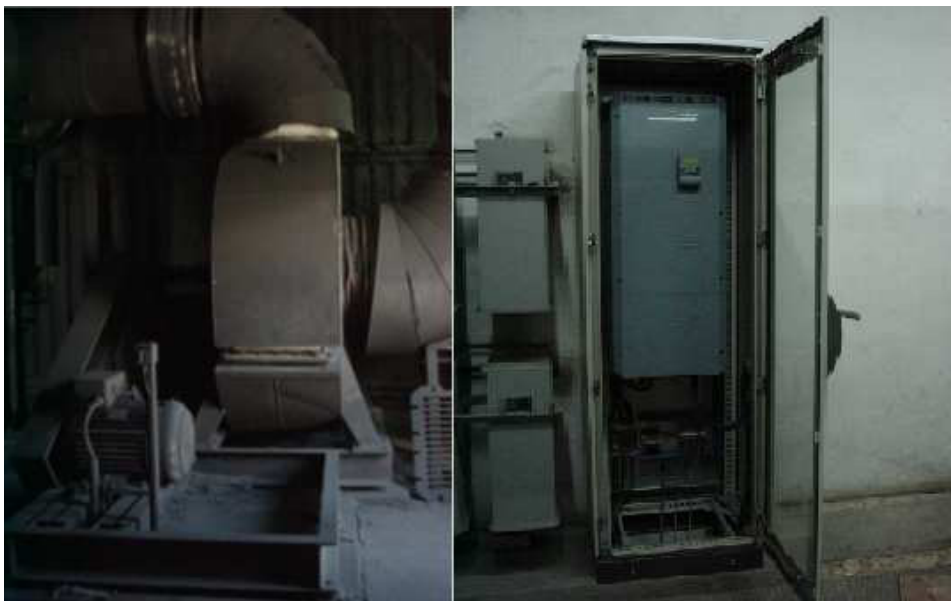
Figura 3.5 – Variador de velocidade e motor do ventilador de transporte de ar quente da moagem de carvão 2
