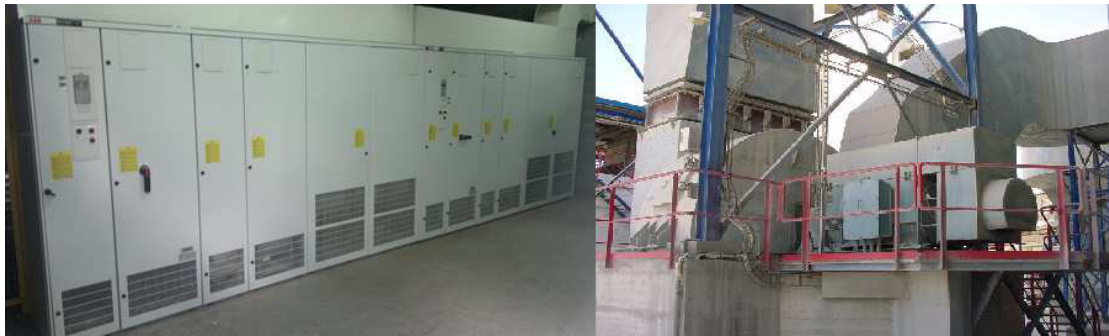
Figura 3.3 – Variador de velocidade e motor do ventilador do filtro de mangas do forno e cru
