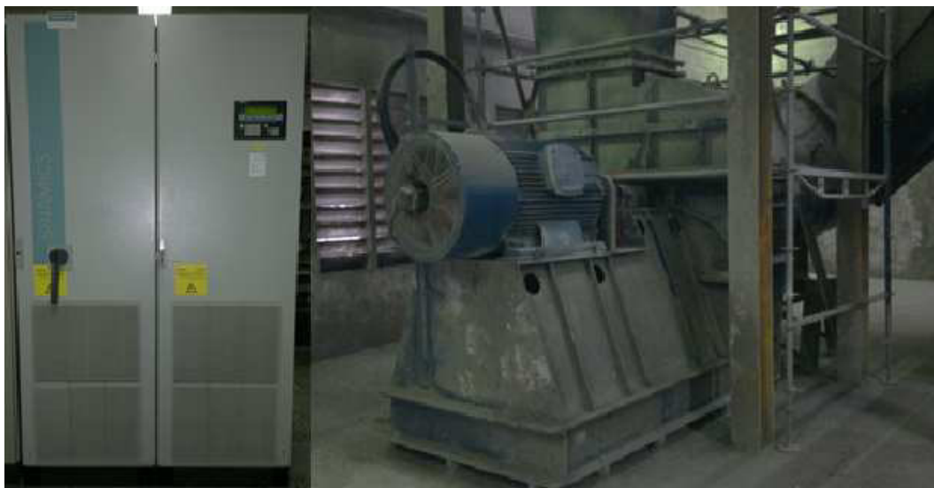
Figura 3.4 – Variador de velocidade e motor do ventilador do filtro de mangas da moagem de cimento 7
