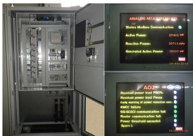
Figura 3.8 – Equipamento de Medição, Comunicação e Controlo (EMCC)
