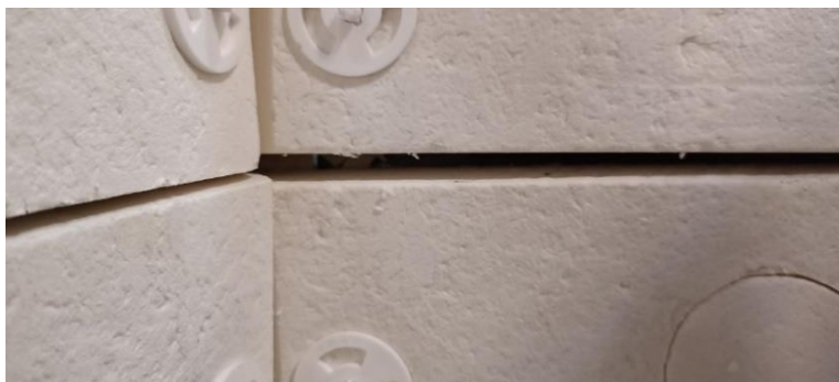
Figura 61 Pormenor da falha na sobreposição das paredes no interior do forno.
