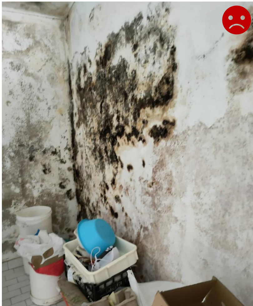
Figura 7: Parede degradada de um armazém para matérias-primas de uma empresa panificadora. (Fonte Própria, 2022)
