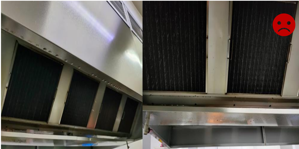
Figura 10: Exemplos de exaustores em mau estado de higienização. (Fonte Própria, 2022)
