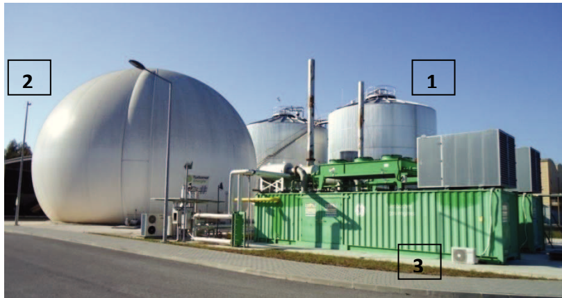
Figura 8: Central de Valorização Orgânica da Valorlis (Leiria). 1 – Digestor; 2 – Gasómetro; 3 – Valorização energética.
