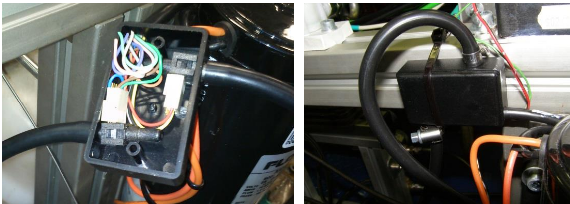
Figura 3.26- Incorporação dos sensores em caixa de proteção.
