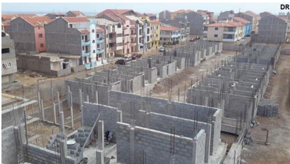
Figura 13 Edifícios de blocos de cimento e betão armado Cabo Verde (Jornal O País , 2020)
