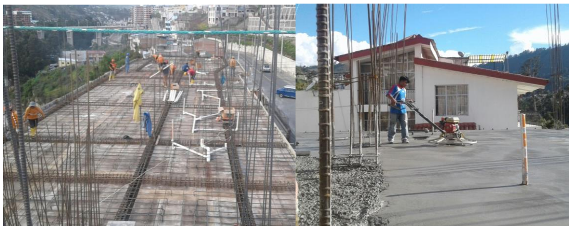
Figura 52. Ausencia de protecciones colectivas como redes anti-caídas o barandas de protección. Fuente: Autor
