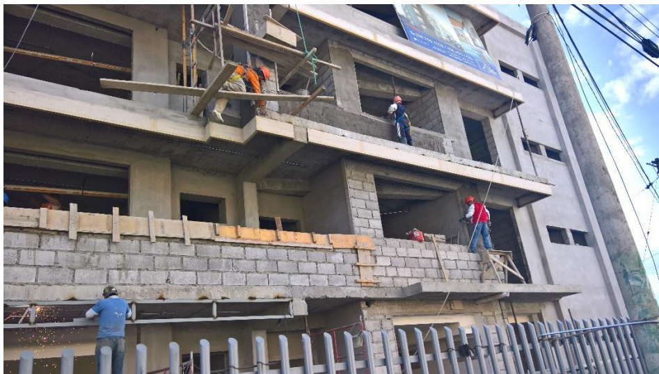
Figura 59. Plataformas de trabajo inadecuadas. Fuente: Autor
