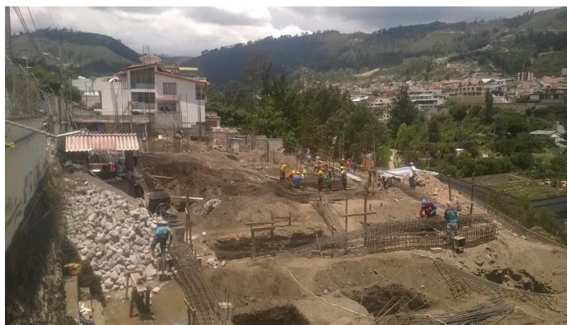
Figura 44. Falta de EPI en algunos trabajadores. Fuente: Autor
