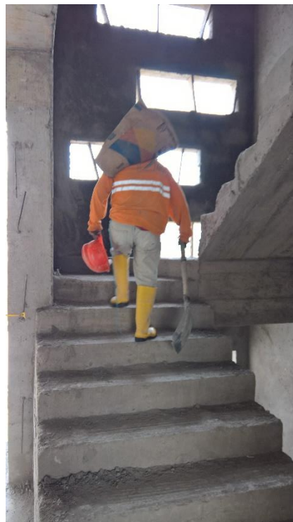
Figura 54. Trabajadores no utilizan cinturón o faja para cargar materiales pesados. Fuente: Autor
