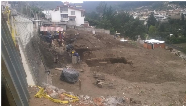
Figura 43. Falta de señalización y delimitación de zonas en la obra. Fuente: Autor
