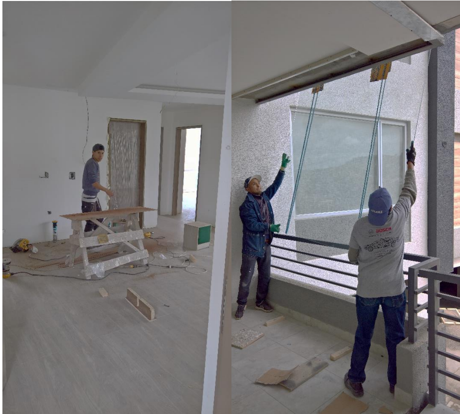
Figura 64. Falta de uso de EPI básicos en los trabajadores. Fuente: Autor
