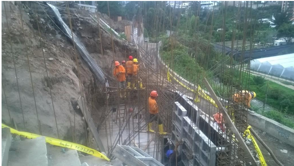
Figura 47. Plataformas de trabajo inestables. Fuente: Autor
