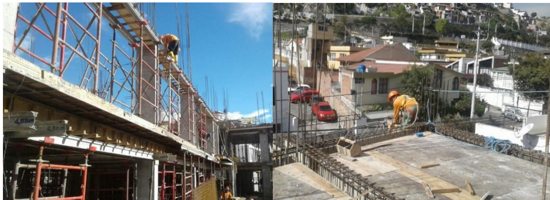
Figura 51. Ausencia de líneas de vida adecuadas para el correcto uso del cinturón de arnés. Fuente: Autor
