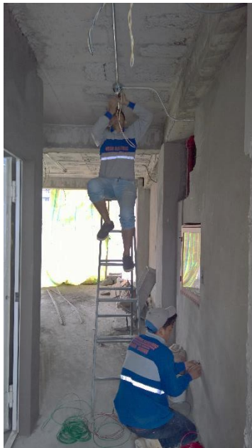
Figura 56. Electricistas no utilizan EPI básicos para su actividad. Fuente: Autor
