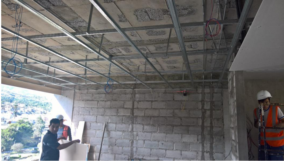
Figura 60. Ausencia de EPI en algunos trabajadores. Fuente: Autor
