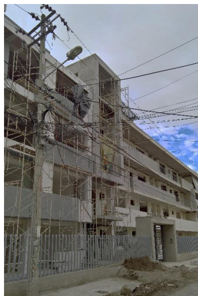
Figura 62. Líneas eléctricas cercanas a la fachada del edificio. Fuente: Autor
