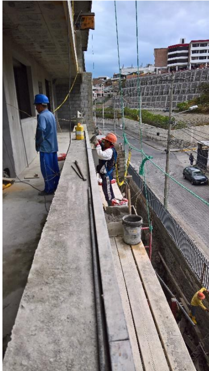
Figura 58. Ausencia de líneas de vida adecuadas. Fuente: Autor
