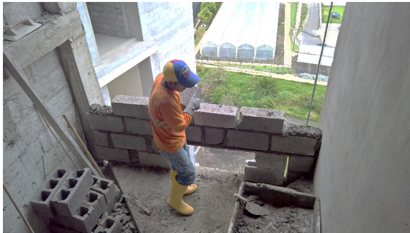
Figura 53. Ausencia en el uso de casco. Fuente: Autor
