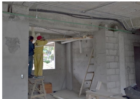
Figura 55. Uso de plataformas de trabajo inestables. Fuente: Autor
