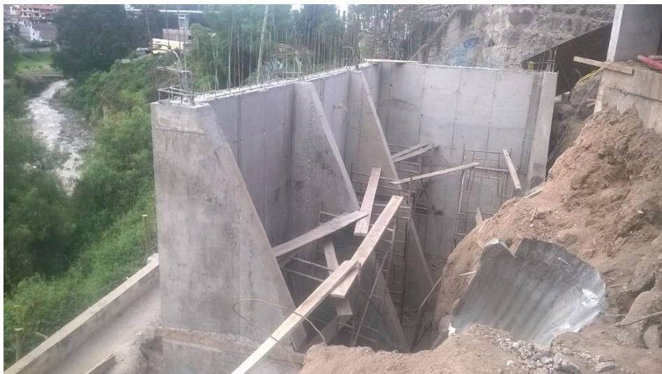
Figura 48. Tablas de madera utilizadas para plataformas de trabajo, sin apoyos estables. Fuente: Autor
