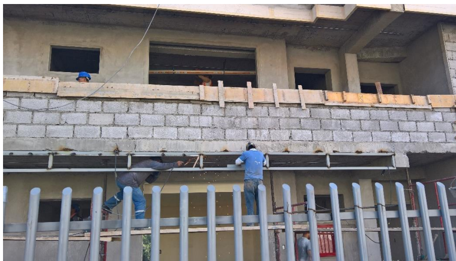
Figura 63. Trabajadores de soldadura no utilizan guantes para la protección de las manos. Fuente: Autor
