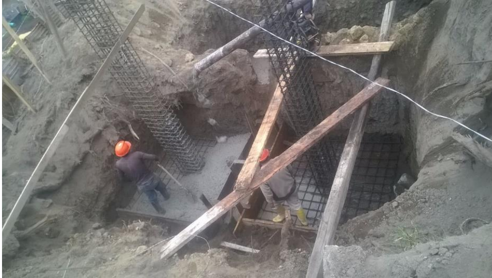
Figura 49. Falta de señalización y delimitación de las zonas de excavación. Fuente: Autor
