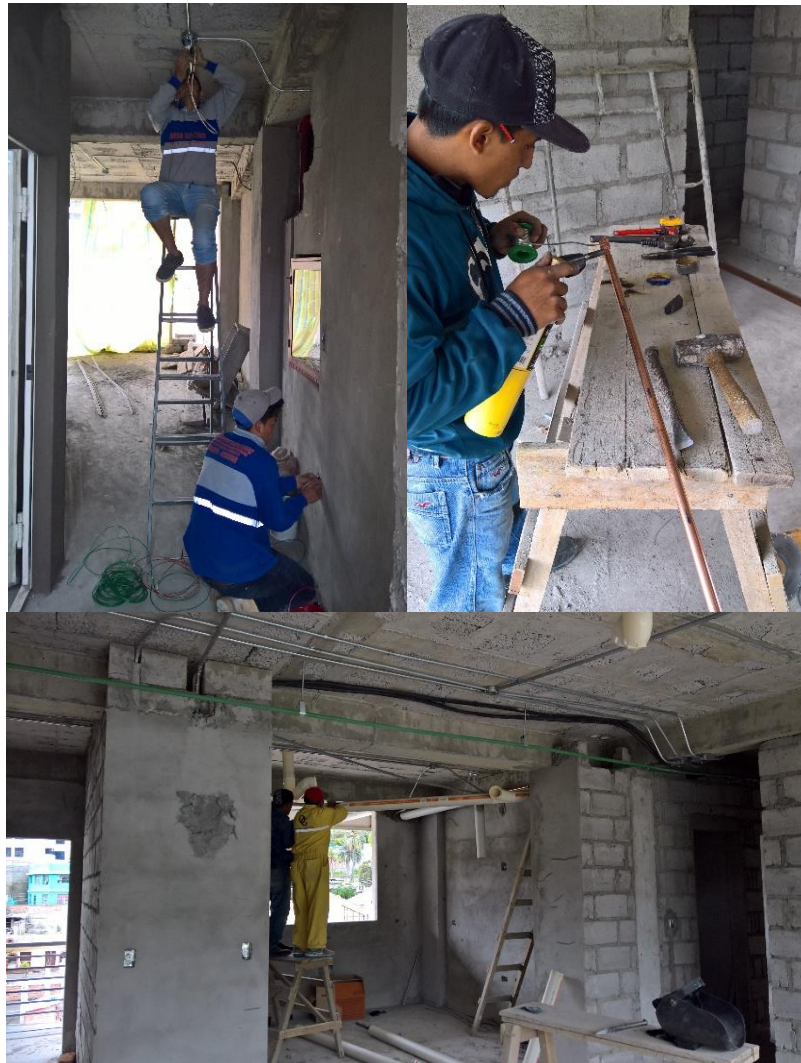
Figura 31. Instalaciones en el Edificio. Fuente: Autor
