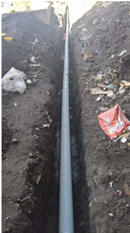
Figura 45. Desorden, falta de señalización y protección en los bordes de la excavación. Fuente: Autor
