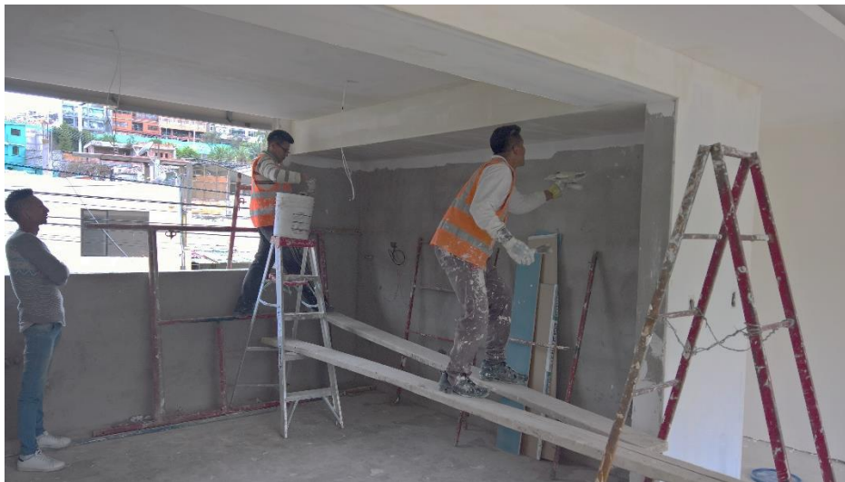
Figura 61. Plataformas de trabajo inestables. Fuente: Autor
