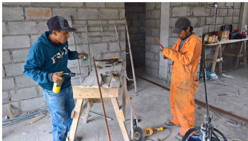
Figura 57. Trabajadores utilizan sopletes de gas propano ausentes de EPI básicos para su protección. Fuente: Autor
