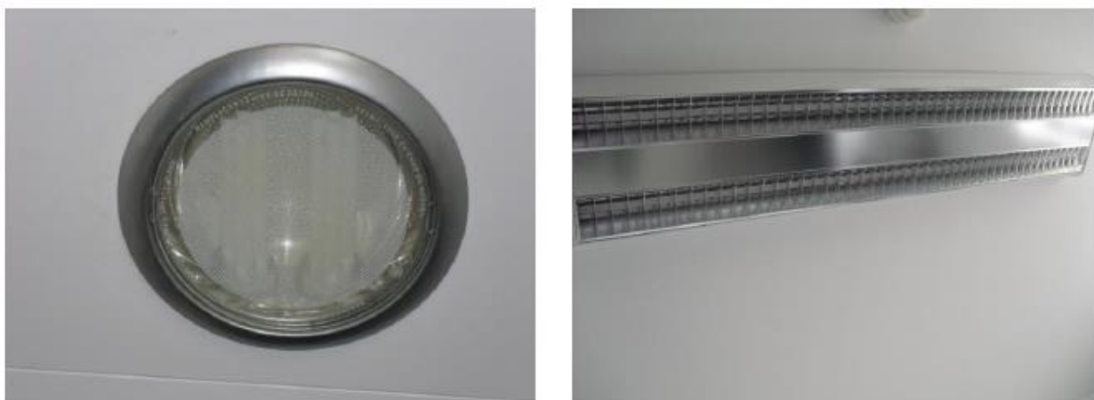
Figura 56: Luminária do tipo CFL e fluorescente do tipo T5.
