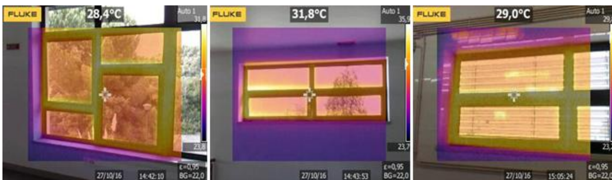
Figura 49: Foto termográfica dos vãos envidraçados – Cantina 3
