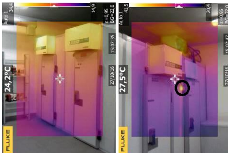
Figura 52: Imagem termográfica das camaras frigoríficas – Cantina 3
