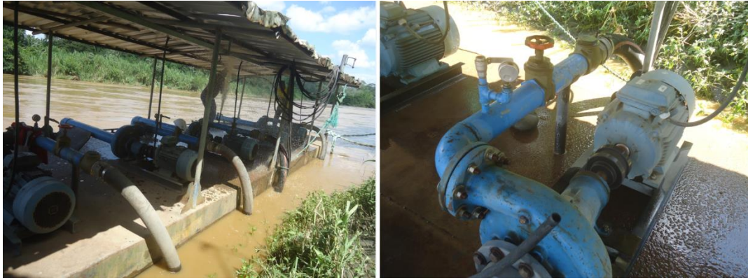
Figura 20. Equipos de bombeo-Estación N°1 Fuente: Autor
