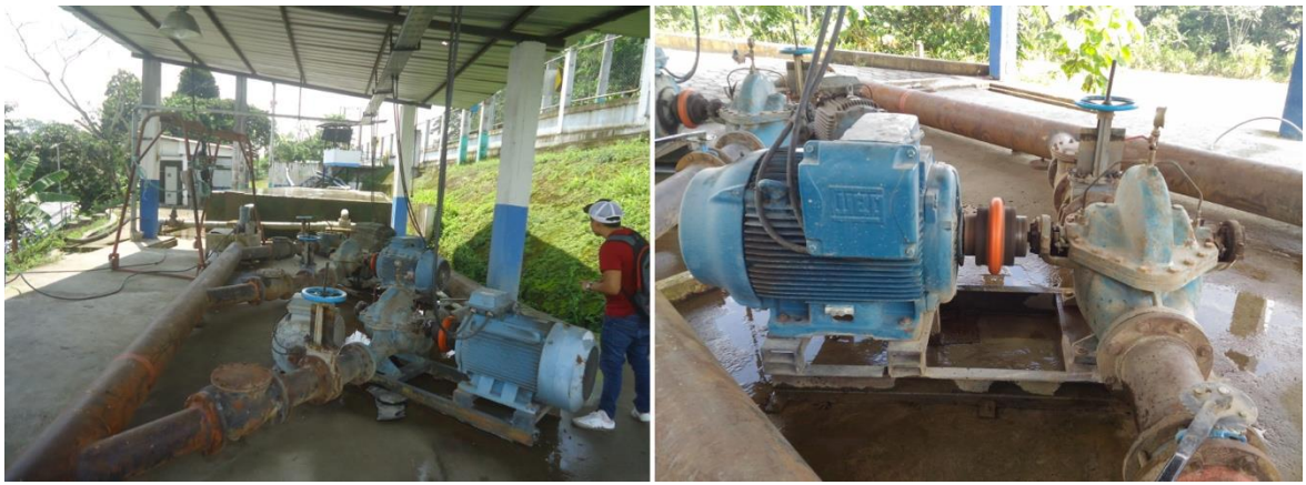
Figura 24. Estación de Bombeo N°2 (izquierda) y conjunto bomba-motor en funcionamiento (derecha) Fuente: Autor
