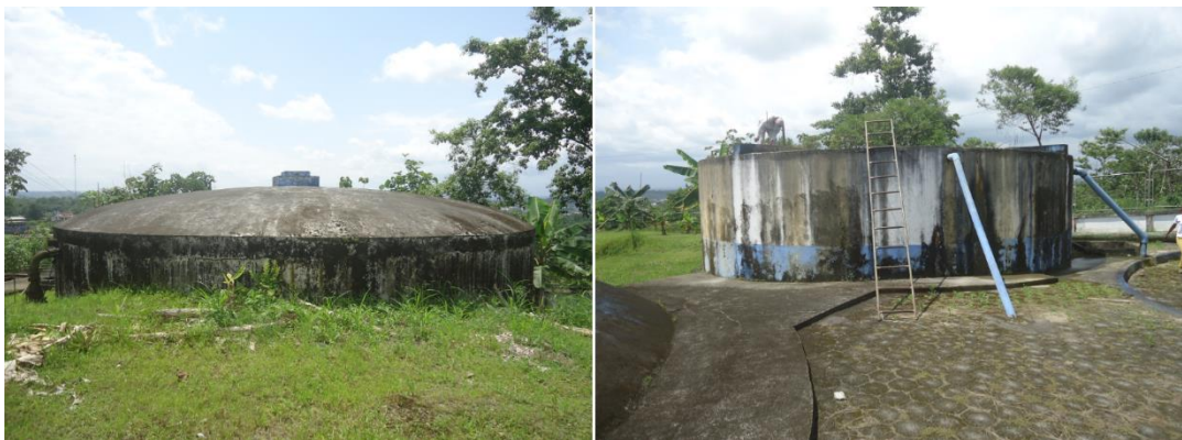
Figura 29. Tanques de 500 m 3 (izquierda) y 300 m 3 (derecha) Fuente: Autor
