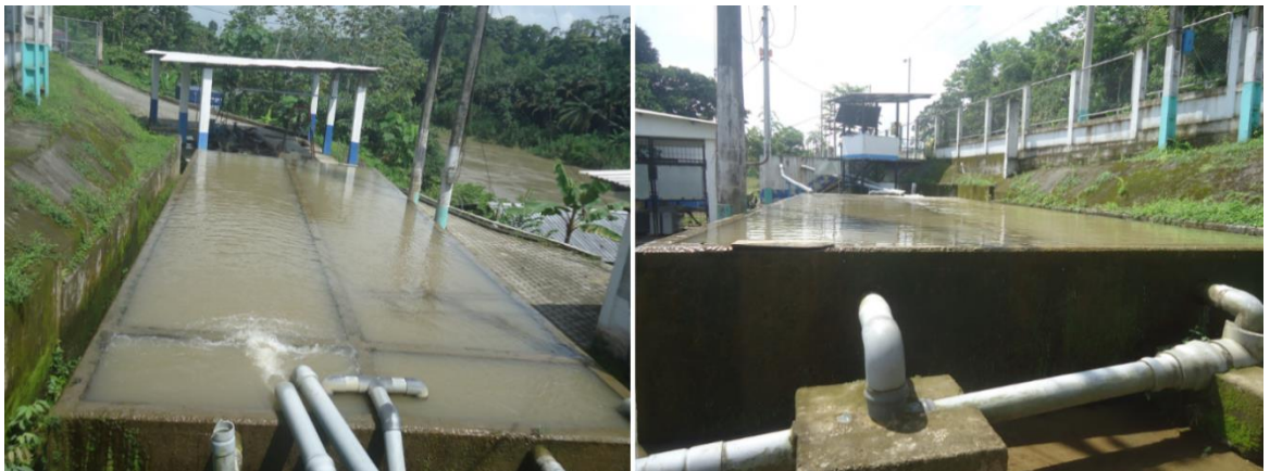
Figura 23. Sedimentador N°2 (izquierda) y tubería de salida a estación de bombeo N°2 (derecha) Fuente: Autor
