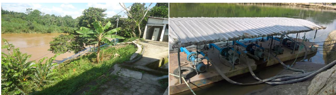
Figura 19. Captación mediante barcaza flotante sobre el río Blanco Fuente: Autor
