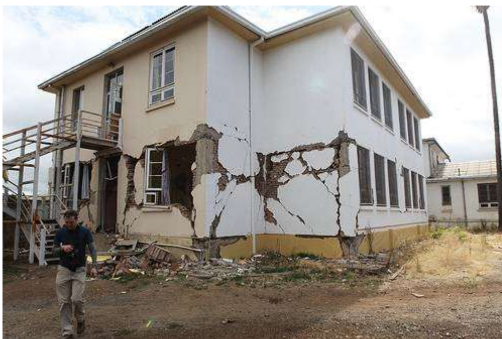
Figura 38. Agrietamiento de paredes de mampostería por efecto de los terremotos.
