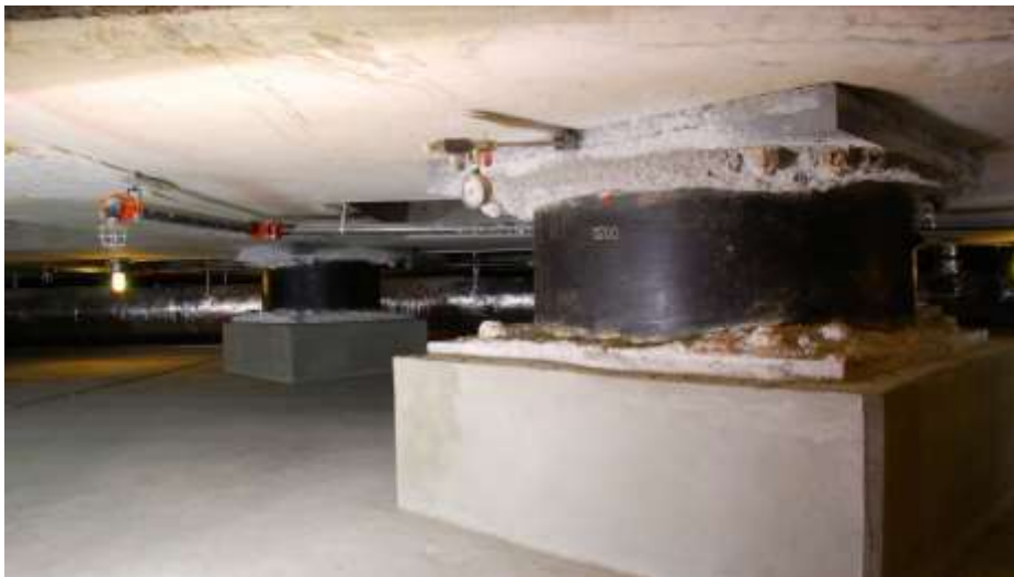
Figura 16. Aisladores de Caucho y Plomo
