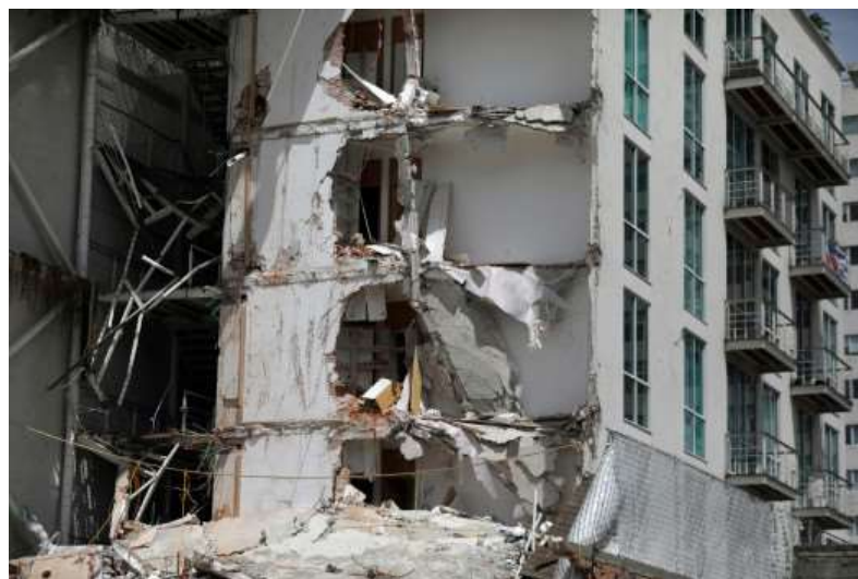
Figura 14. Edificio en México construido con losas planas que fue parcialmente destruido en el terremoto de 7.1 grados en 2017.
