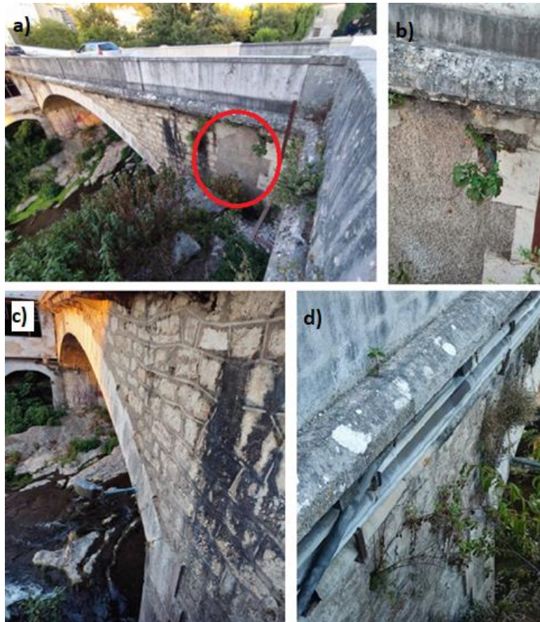
Figura 62: Danos no muro de Tímpano – a) e b) ausência de alvenaria de revestimento, c) manchas negras, d) vegetação - Ponte Hintze Ribeiro
