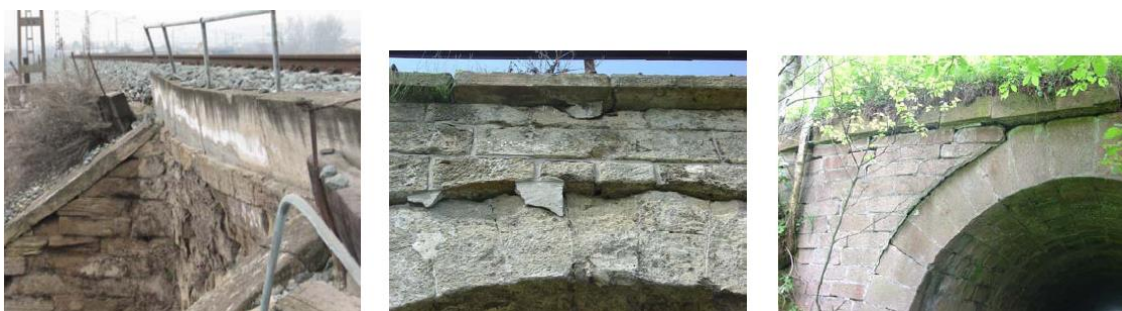
Figura 33: Anomalias nos muros de Tímpano (Lopes, 2012)
