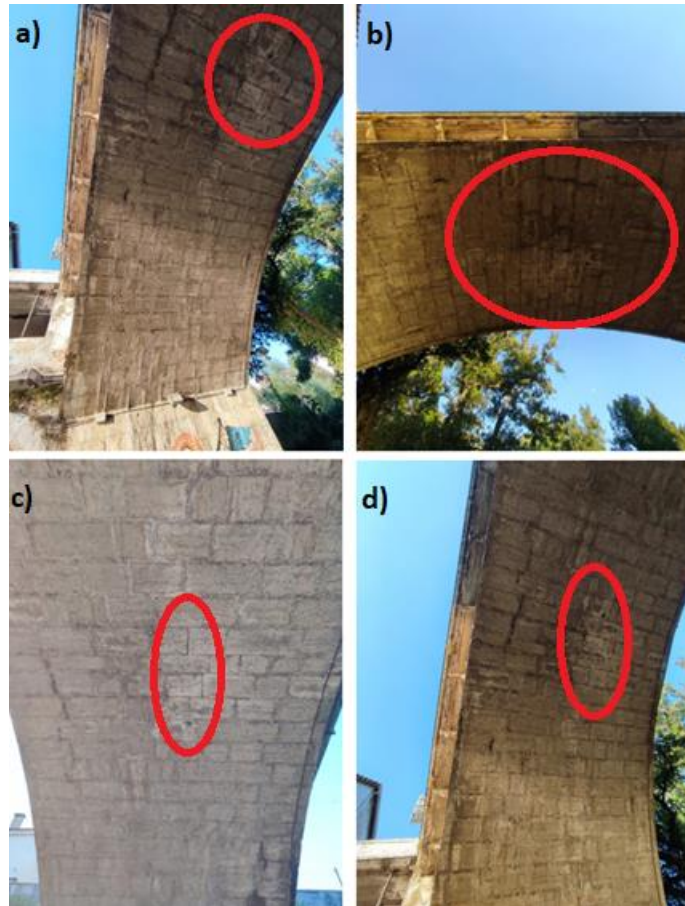
Figura 64: Danos no intradorso – a), b) e d) presença de agentes biológicos e eflorescência c) ausência de argamassa nas juntas de vedação - Ponte Hintze Ribeiro
