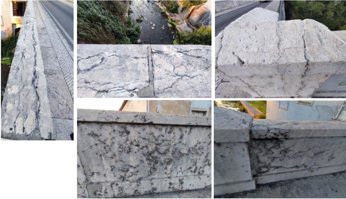
Figura 68: Danos nos Guarda-corpos - Fissuras e degradações nas pedras - Ponte Hintze Ribeiro
