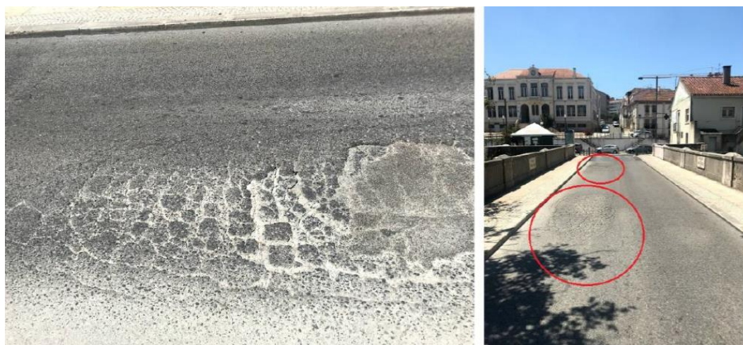
Figura 57: Danos no pavimento betuminoso observados em inspeção anterior – Ponte Hintze Ribeiro – (Ostetto, 2019)
