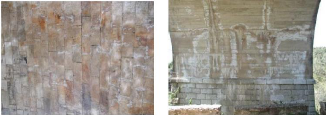
Figura 38: Exemplos de eflorescências (Catalán e Álamo 2006 apud Lopes, 2012)
