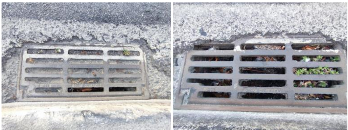
Figura 63: Danos no sistema de drenagem – Grelhas obstruídas - Ponte Hintze Ribeiro
