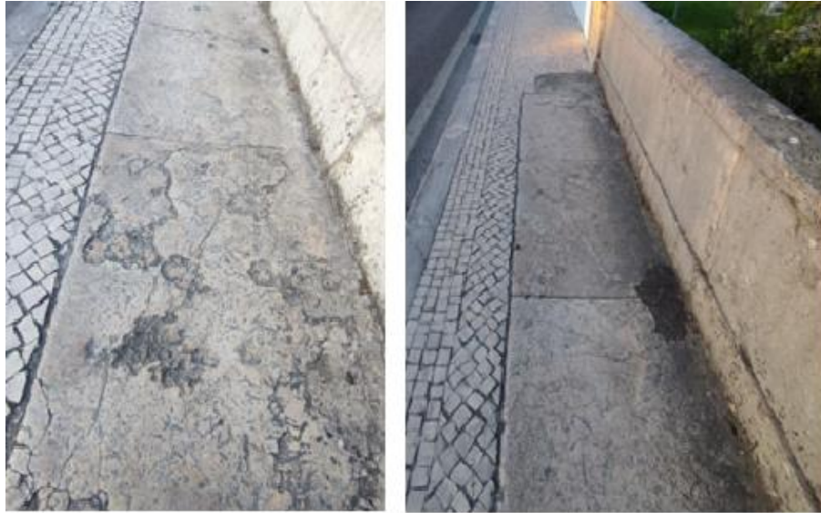
Figura 59: Danos no passeio – Desgaste das pedras - Ponte Hintze Ribeiro
