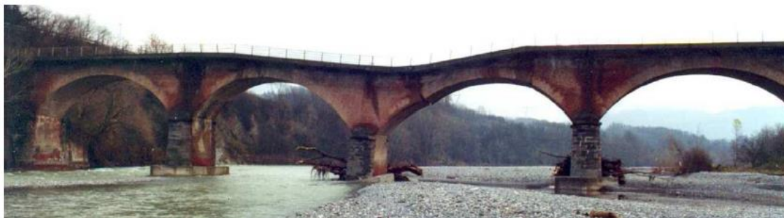
Figura 36: Mecanismo de rotura por perda de capacidade das fundações na ponte Vignole (Brencich, 2007, apud Costa, 2009).
