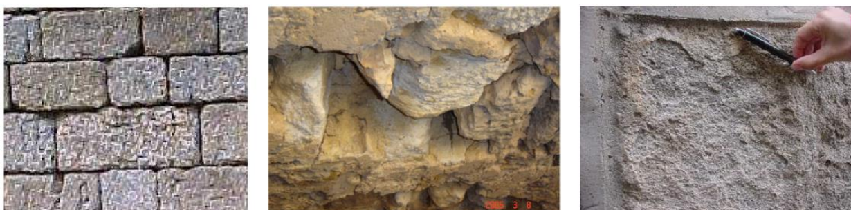
Figura 41: Exemplo de erosão, dissolução e desagregação da alvenaria de pedra (Lopes, 2012)
