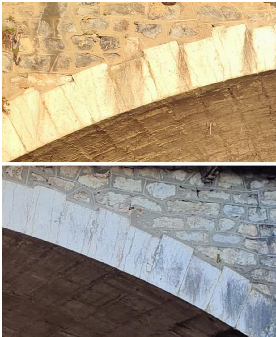
Figura 65: Danos nas Aduelas - Fissuras e manchas negras - Ponte Hintze Ribeiro
