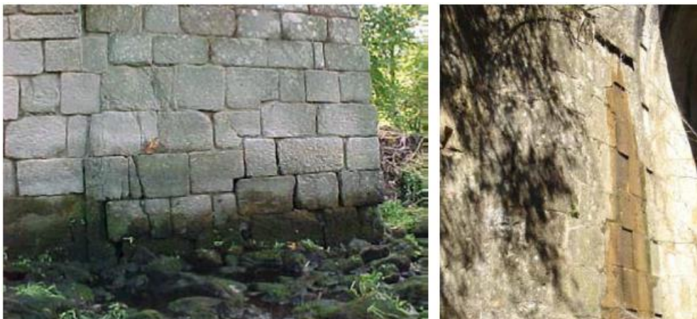
Figura 39: Exemplos de manchas de humidade, escorrências e depósitos de água (Costa, 2009)
