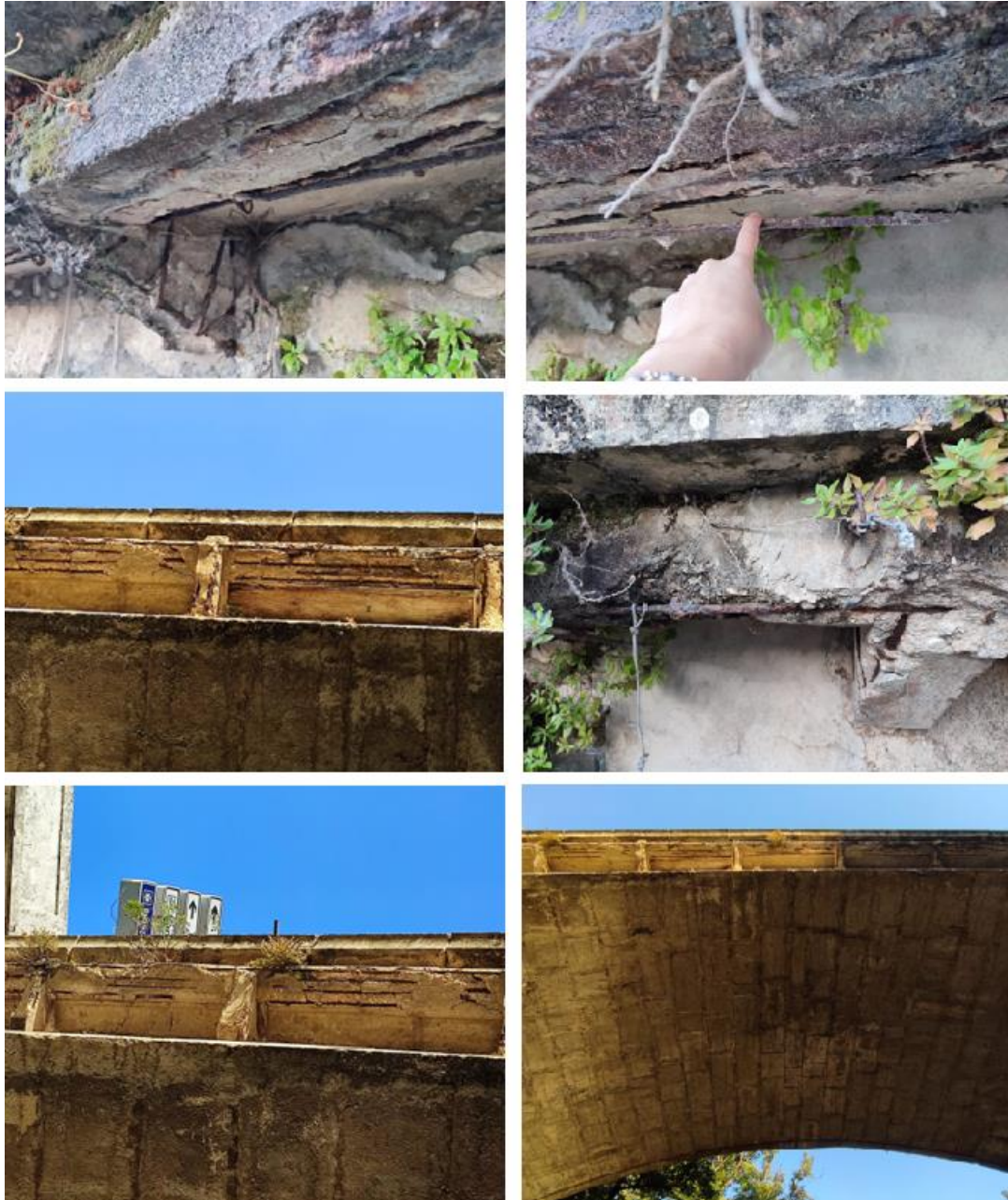
Figura 61: Danos no tabuleiro- Armaduras expostas na viga longitudinal e consolas curtas - Ponte Hintze Ribeiro
