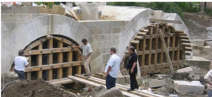
Figura 19: Início da construção do muro tímpano de montante entre os arcos 1 e 2 (P. Costa, 2007)
