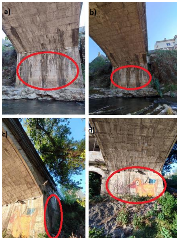
Figura 66: Danos nos pilares - Ponte Hintze Ribeiro
