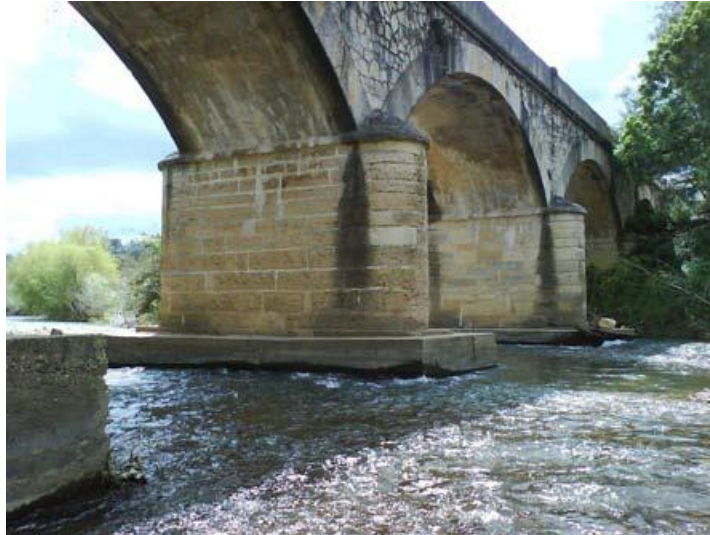
Figura 21: Formas dos pilares da ponte do Prado (Ferreira e Serra, 2007, apud Costa, 2009).
