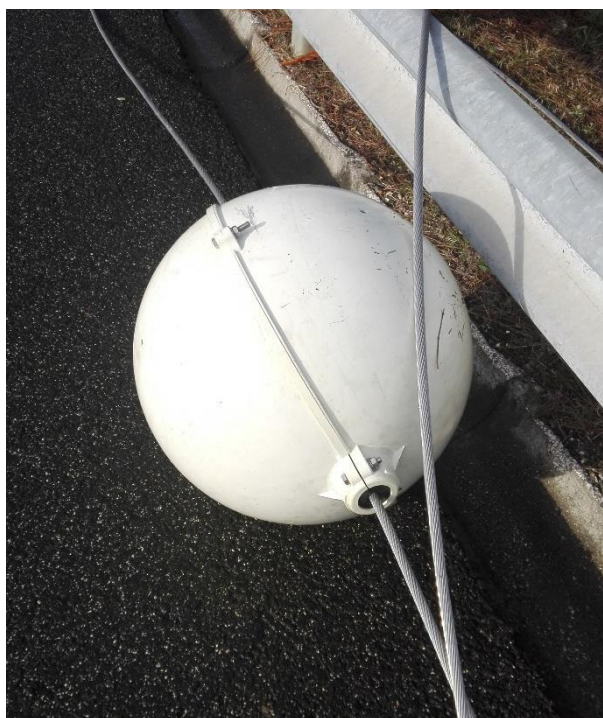
Figura 7 - Bola de Sinalização Diurna.
