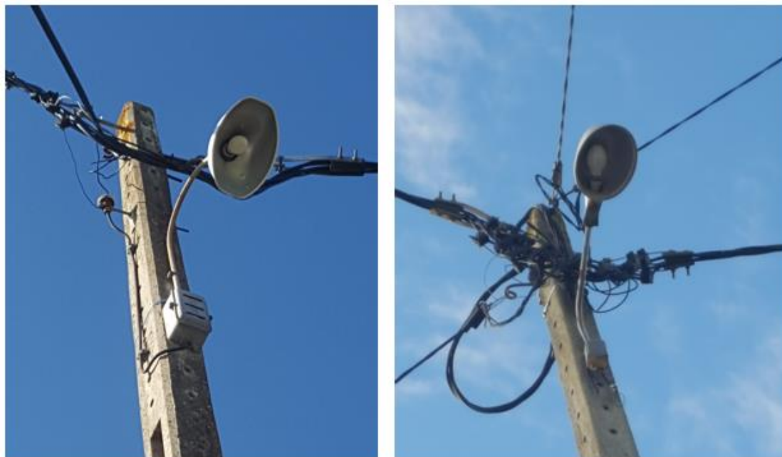
Figura 4-6 - Luminárias Obsoletas – Rural Abertas
