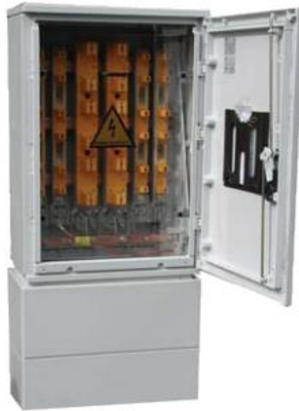
Figura 4-20 - Armário de Distribuição Tipo W Jayme Costa
