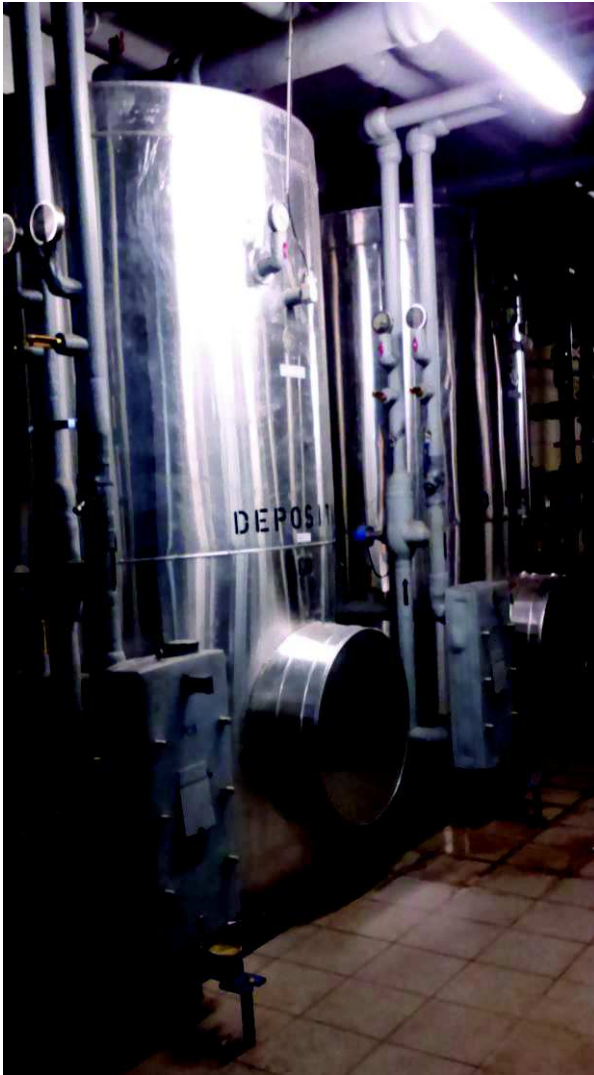
Depósito água quente MBC e Hotel
