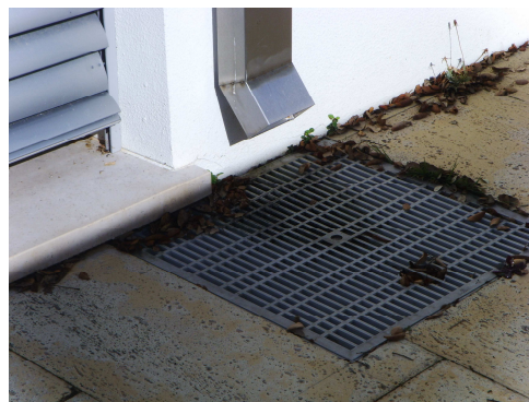
Figura 19- Caixa de recolha de água junto às paredes
