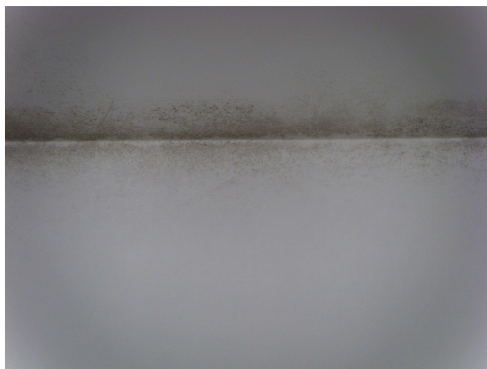
Figura 40- Humidade de condensação na parede e teto da sala de aula da primária
