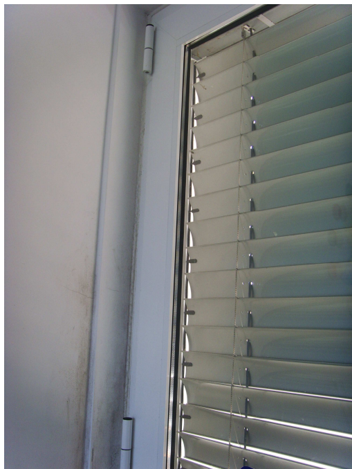
Figura 39- Humidade de condensação em enquadramento de vãos
