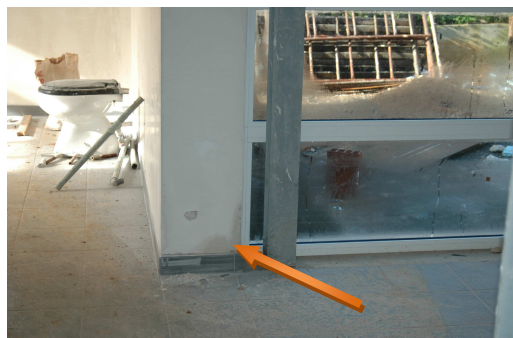
Figura 23- Manchas de humidade por acumulação de água da condensação que vem dos envidraçados
