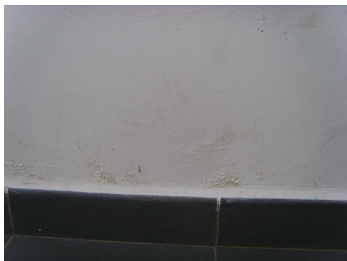
Figura 18- Manifestações de humidade em paredes de pedra
