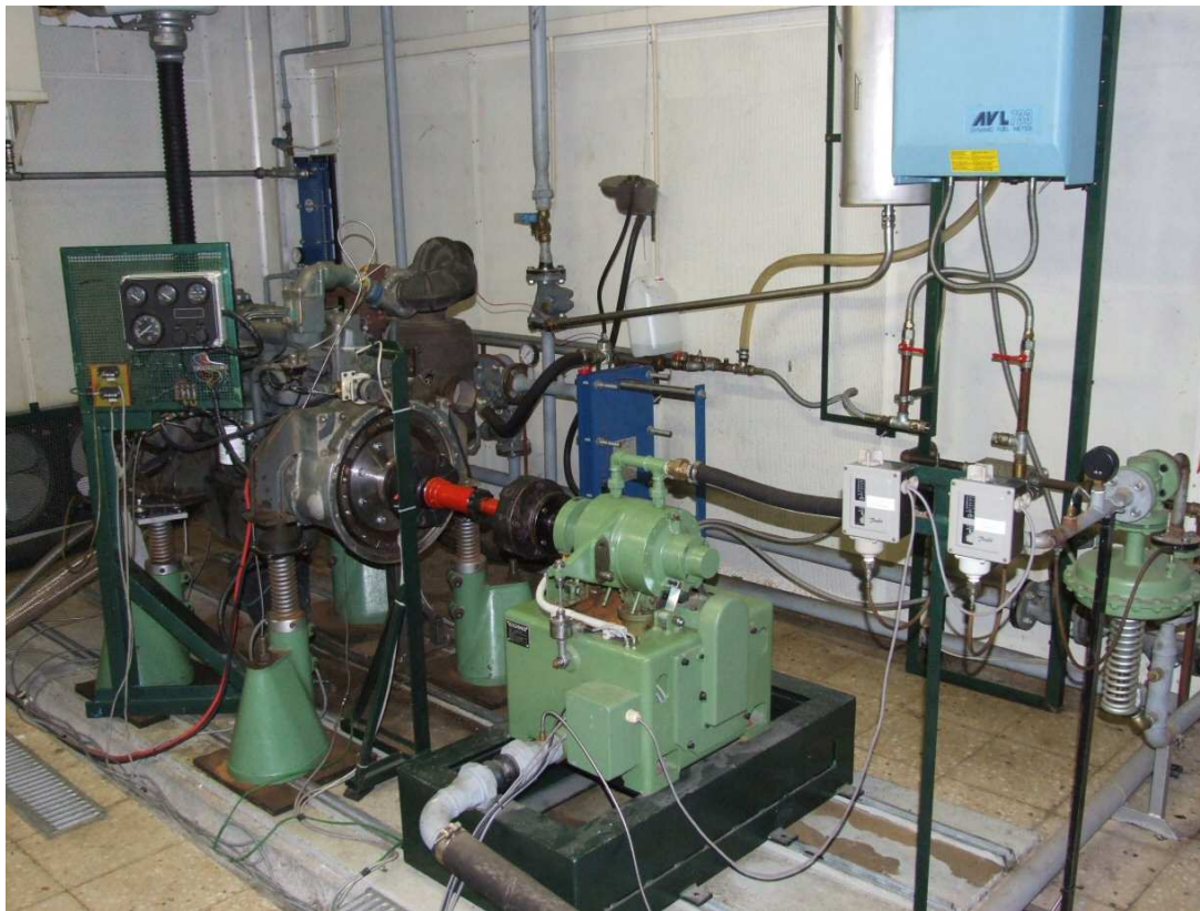
Fig. 3.2 – Vista do motor acoplado no dinamómetro, com restantes equipamentos anexos.
