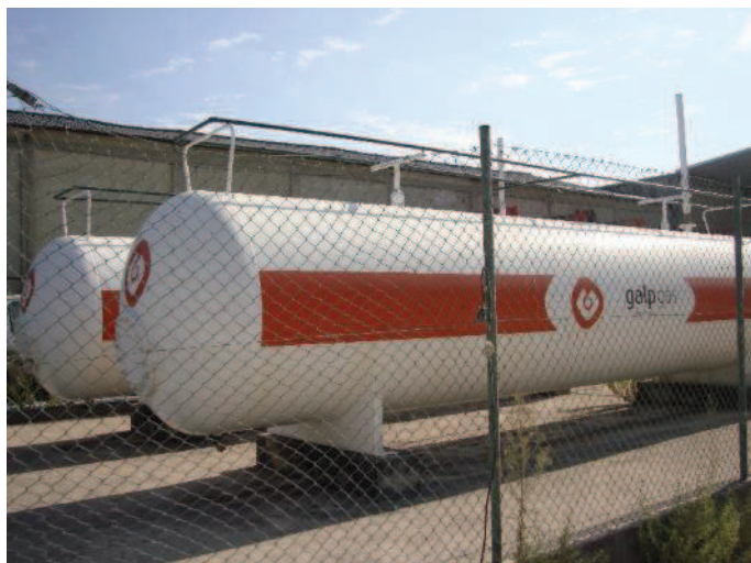
Figura 5 – Cisternas, depósito de Gás
