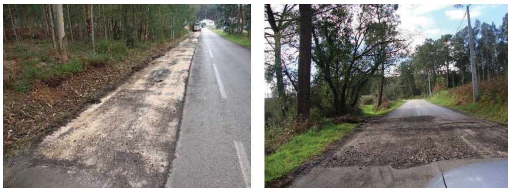
Figura 85 - Pavimentos rodoviários danificados, infiltração das raízes dos pinheiros (Souto da Carpalhosa)
