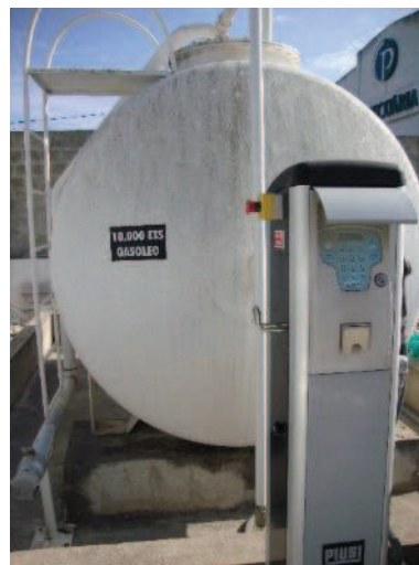
Figura 6 – Depósito de Gasóleo 10.000 LTS
