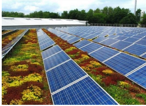
Figura 4 - Telhado verde fotovoltaico (Rocha, 2016).
