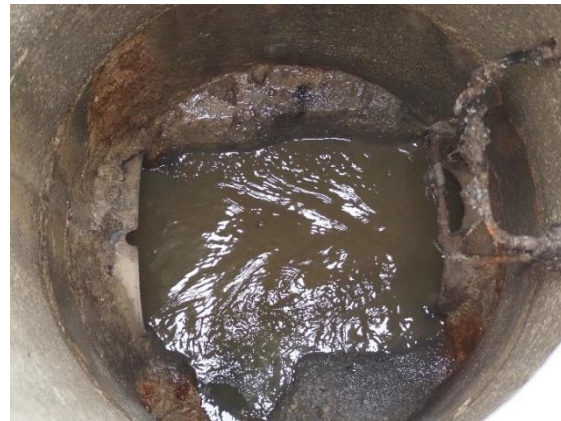
Figura 82 - Paredes e fundos degradados por corrosão das superfícies devido possivelmente á ocorrência de grandes concentrações de H 2 S no interior das Caixas de visita
