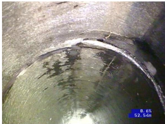
Figura 13 - Fissuras reticulares das 02 até 04 (HPCII) (5)
