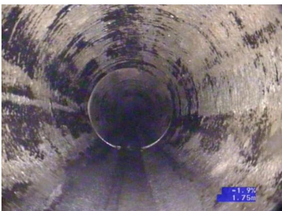
Figura 68 - Corrosão interior (HPC2)
