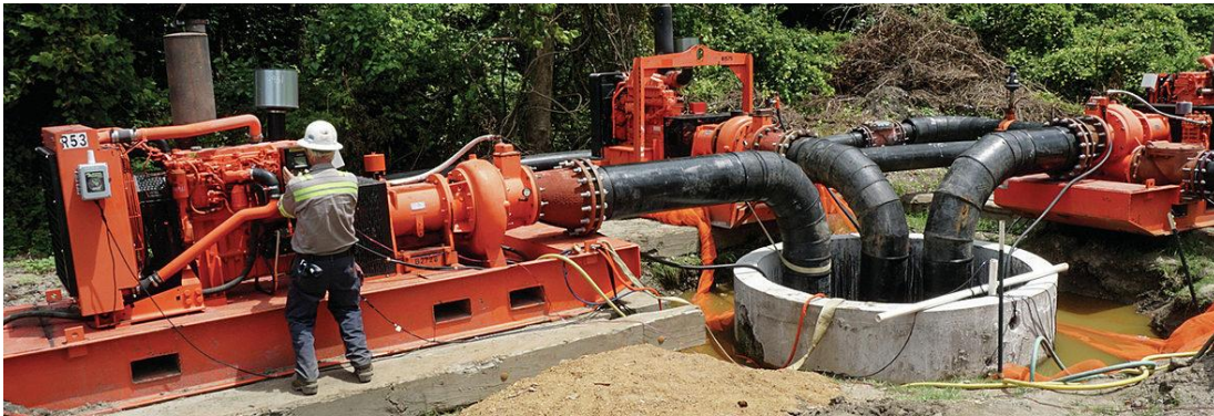
Figura 23 - By-pass - Ponto crítico (9)
