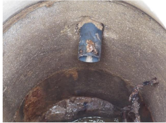
Figura 80 - Elemento estruturais partidos ou fissurados, a corrosão avançada do degrau demonstra a possível presença de H 2 S
