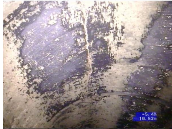
Figura 71 - Fissura longitudinal (HPC2)
