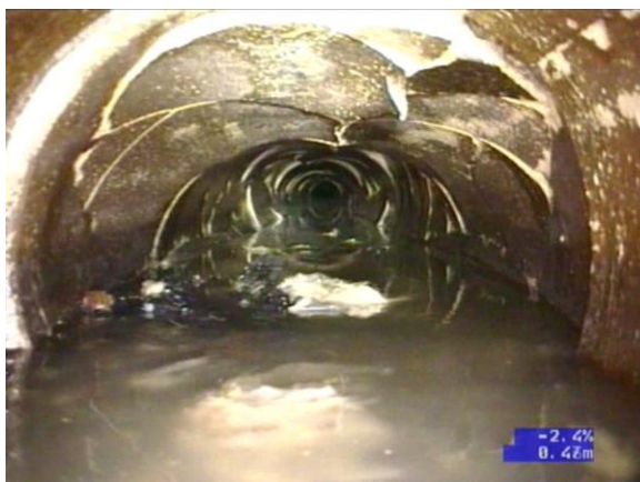
Figura 15 - Fissuras de grandes dimensões multidirecionais – Colapso Eminente (5)
