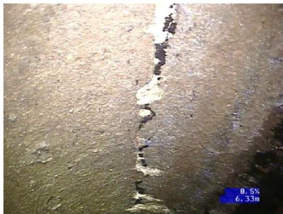
Figura 14 - Fissura longitudinal às 02 Horas, com humidade visível. Largura 0.3 cm (HPCIII) (5)
