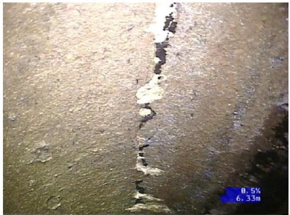
Figura 73 - Fissura longitudinal (HPC3)
