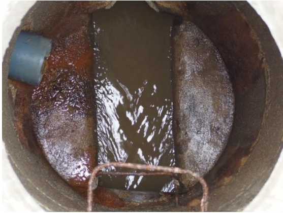
Figura 79 - Desgaste geral das superfícies da caixa de visita, infiltrações nas juntas e fundo
