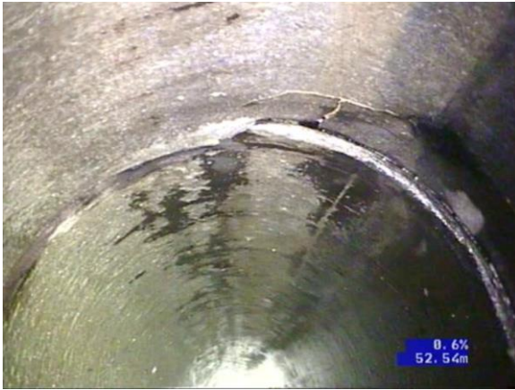
Figura 70 - Fissuras reticulares (HPC2)
