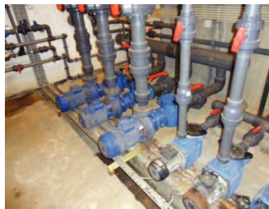
Figura 2 – Bombas de água
