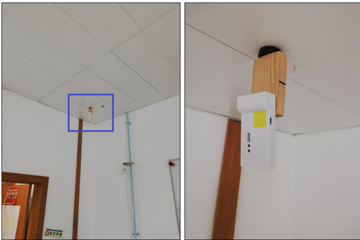
Figura 25: Exemplo de fixação da âncora no teto metálico. Na Figura do lado esquerdo, o retângulo azul representa o local onde a âncora está instalada.
