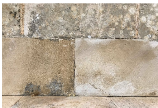
Figura 3.6 – Exemplo de Manchas de humidade
