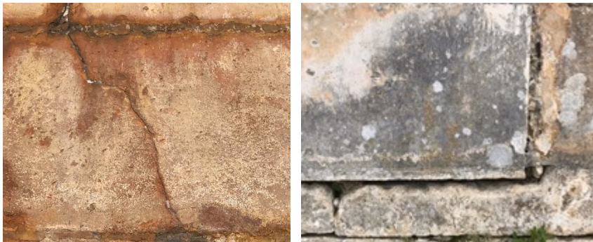
Figura 3.7 –Exemplo de Fissura e Juntas abertas
