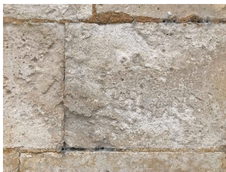
Figura 3.3 – Exemplo de Degradação Granular
