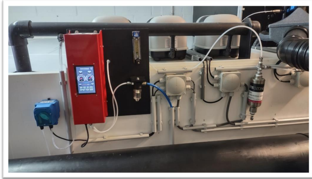
Figura 16 - Gerador de ozono.
