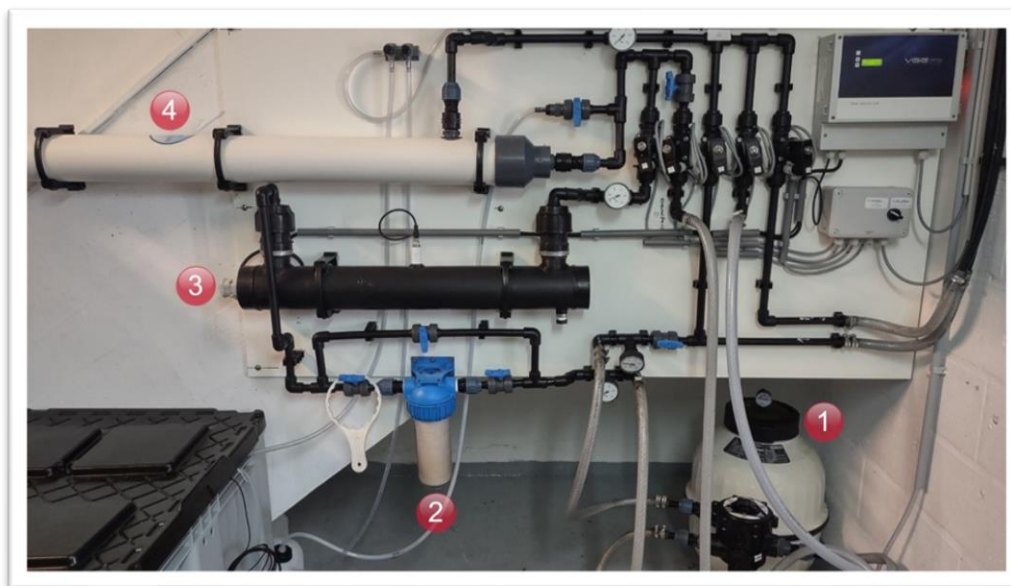
Figura 9 - Sistema de filtração de entrada de água nas instalações. N o 1 Filtro de areia; N o 2 Filtro de cartucho; N o 3 Filtro de luz ultravioleta; N o 4- Membrana de ultrafiltração
