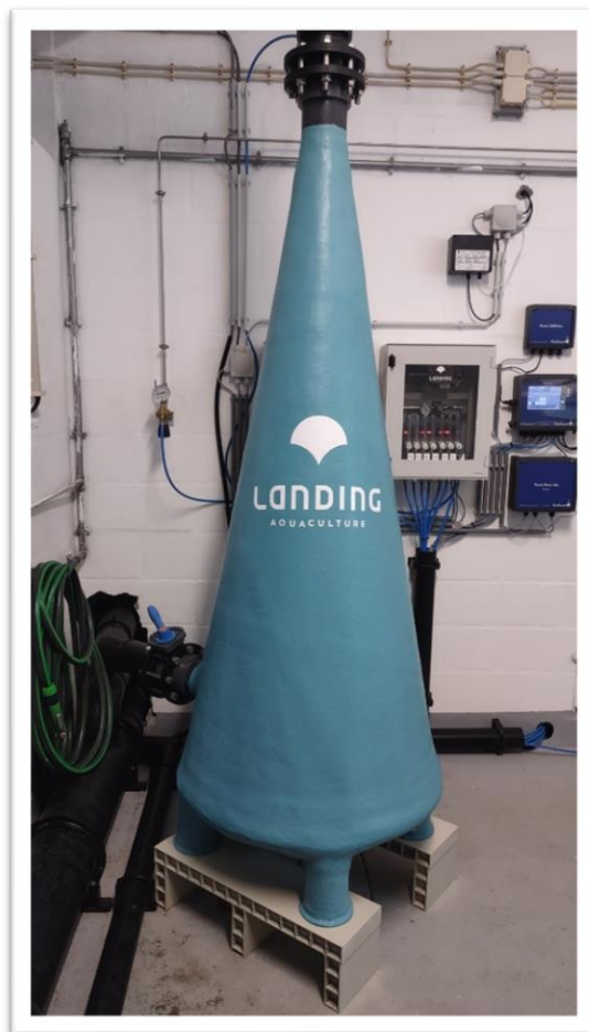
Figura 15 - Cone de oxigénio usado nas instalações.
