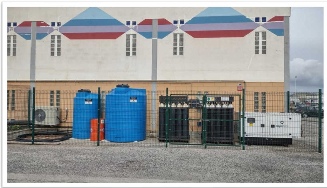
Figura 8 - Parte exterior traseiras do edifício, com sistema de armazenamento de água, garrafas de oxigénio líquido, e gerador de emergência.
