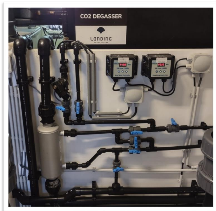
Figura 10 - Sistema de entrada da água na sump , com o cilindro do permutador de calor à esquerda
