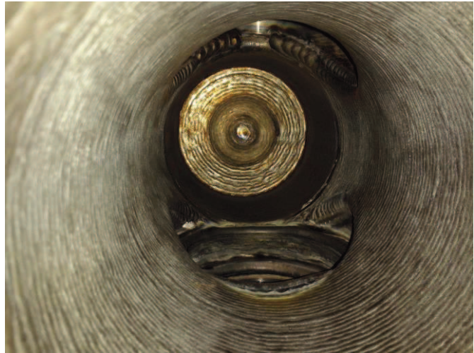
Figura 34 - Válvula após revestimento
