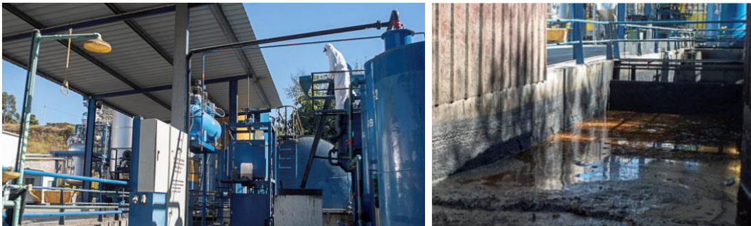
Figura 5 – Unidade de tratamento de águas oleosas (a) e cais de descarga de viaturas (b)
