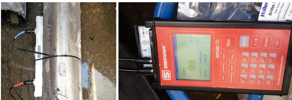
FIGURA 6 CAUDALÍMETRO PORTÁTIL - TRANSDUTOR E CONSOLA
