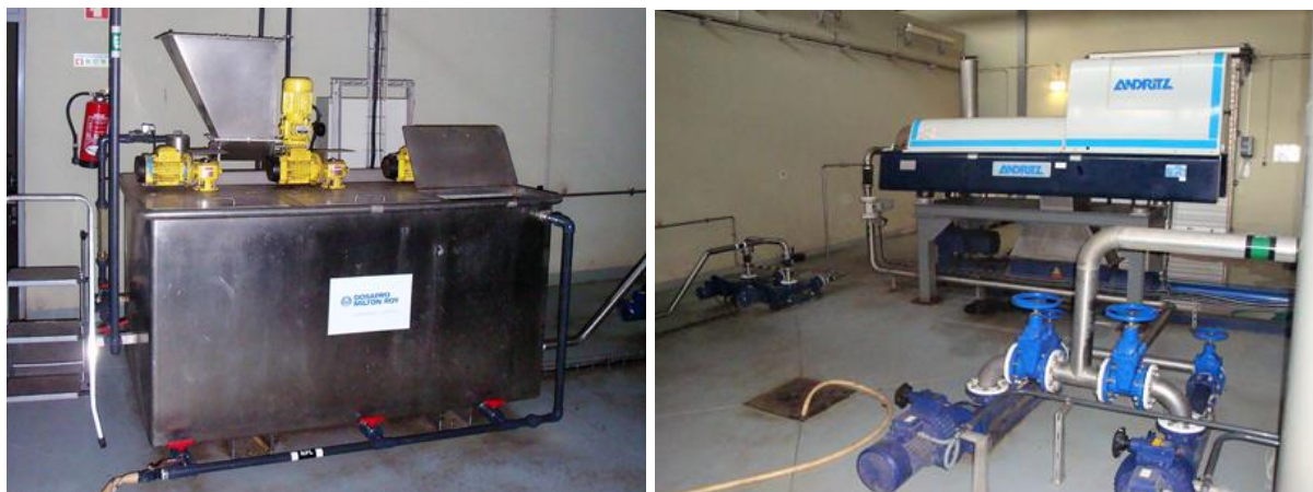
FIGURA 16 EQUIPAMENTOS DE DESIDRATAÇÃO DE LAMAS DA ETAR DA CHARNECA
