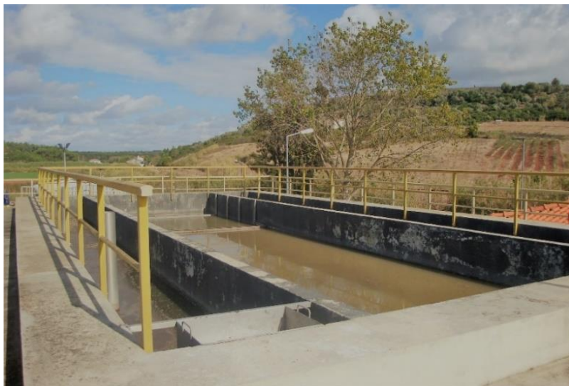
FIGURA 10 TANQUE IMHOFF DA ETAR DE ÓBIDOS
