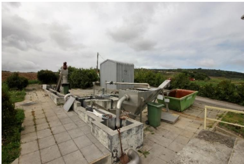
FIGURA 9 OBRA DE ENTRADA DA ETAR DE ÓBIDOS
