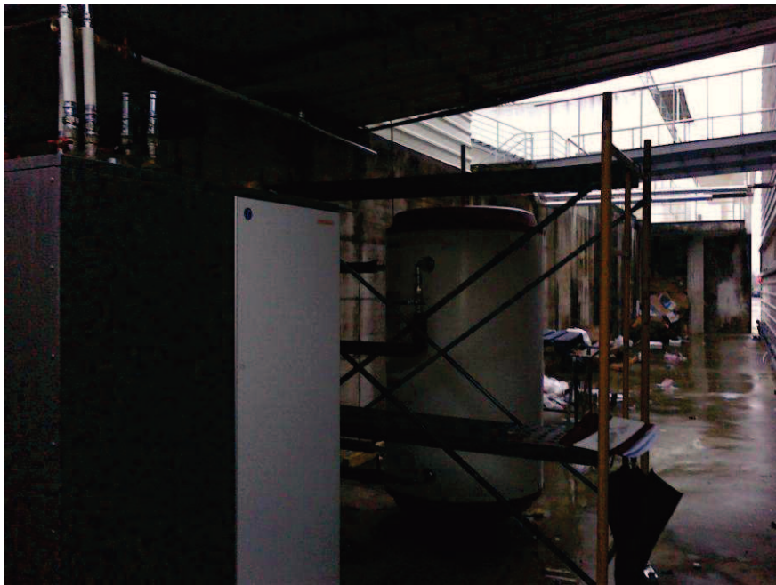
Figura 15 - Vista geral da bomba de calor geotérmica, no edifício E.
