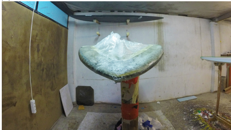
38. Etapas do processo: acabamento dos “rails” com resina reforçada com fibra de vidro
