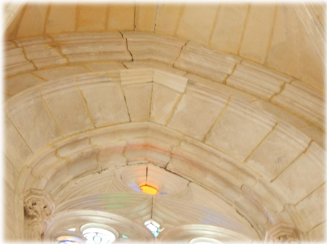
Figura 45 – Exemplo de Fissuração nas zonas de maior tensão (Vazão, 2015)
