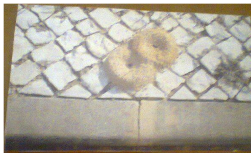
Fotografia 11 - Fotografia representativa de um formigueiro construído na calçada
