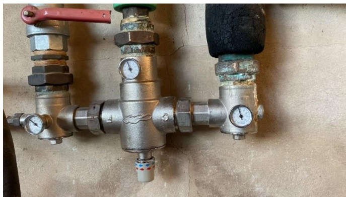
Figura 17 - Tubos de caldeira de aquecimento de água. Fonte: Autorial própria.
