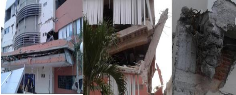
Figura 2.17: Daños observados en la Clínica San Antonio, mecanismo viga fuerte-columna débil. Fuente: (Aguiar & Mieles, 2016)
