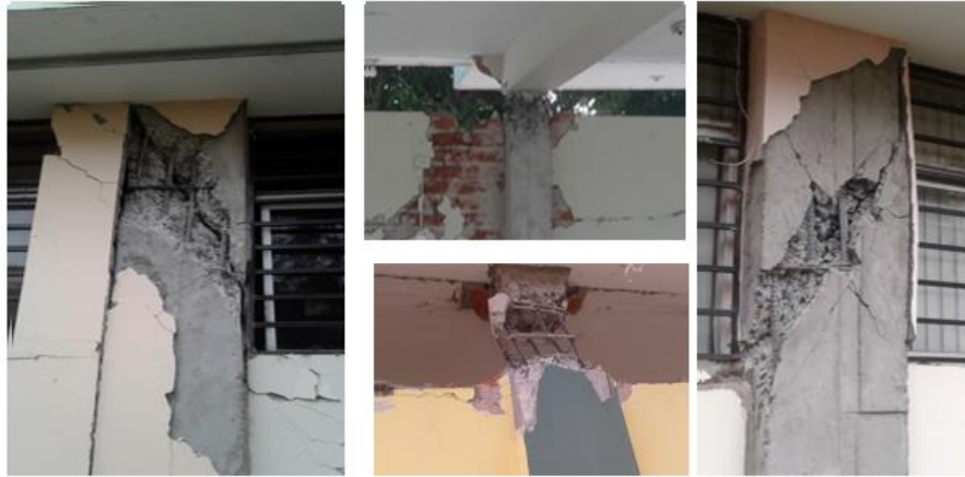
Figura 2.15: Daños por efecto de (columna corta) registrado en varias edificaciones de Portoviejo. Fuente: (Aguiar & Mieles, 2016)
