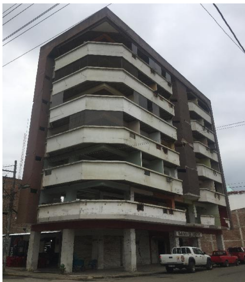
Figura 3.5: Edificio parcialmente abandonado en la ciudad de Portoviejo.
