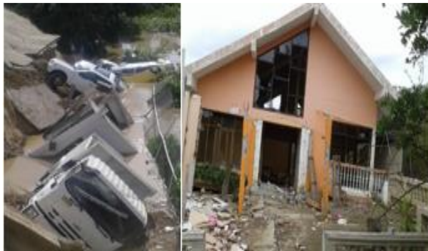
Figura 2.23: Fallas estructurales por licuefacción de suelos. Fuente: (Aguiar & Mieles, 2016)
