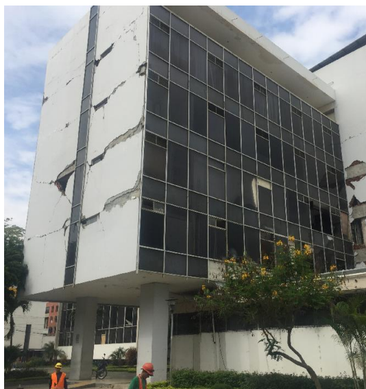
Figura 3.10: Edificio con presencia del mecanismo de piso blando en la Ciudad de Portoviejo
