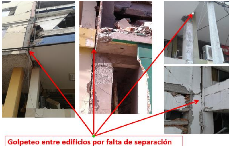
Figura 2.22: Fallas por golpeteo entre edificaciones por falta de separación.
