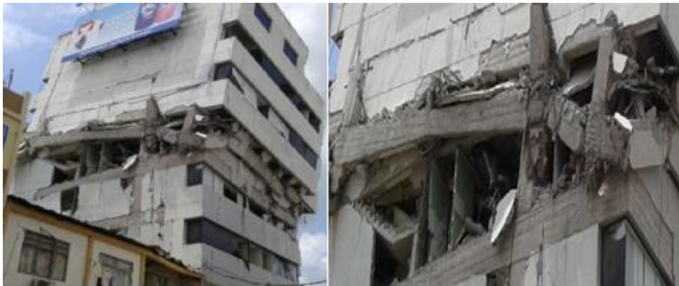
Figura 2.16: Daño en columnas de nivel 5 del edificio Mutualista Pichincha. Fuente: (Aguiar & Mieles, 2016)
