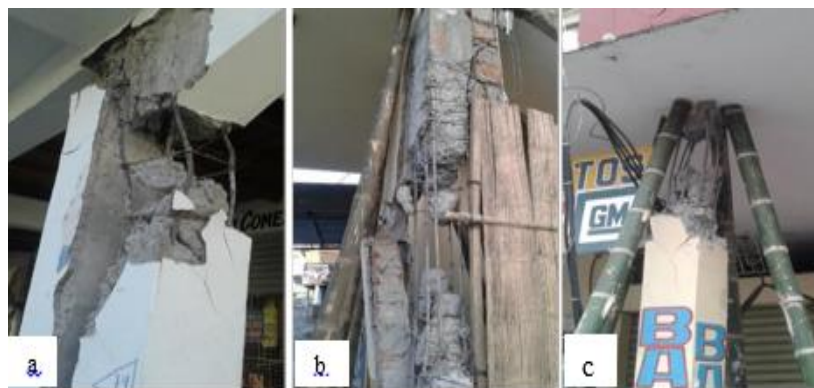
Figura 2.18: Falla por falta de confinamiento en columnas; a) estribos muy separados; b) estribos de 6 mm; c) no se aprecia el estribo. Fuente: (Aguiar & Mieles, 2016)
