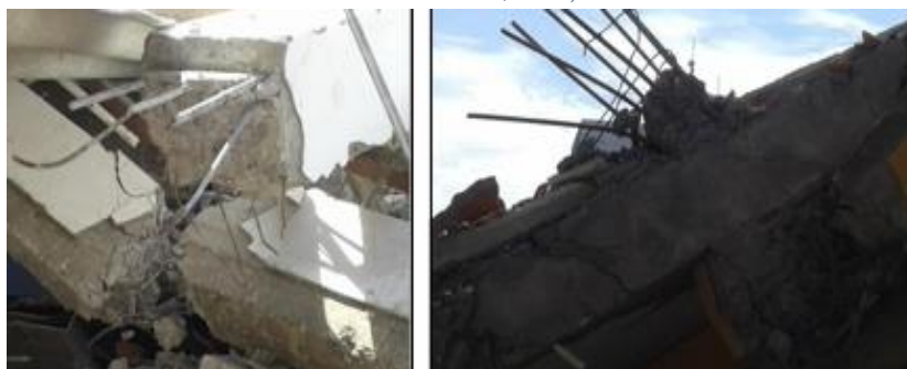
Figura 2.20: Columna con traslape y detallado deficiente. Fuente: (Aguiar & Mieles, 2016)
