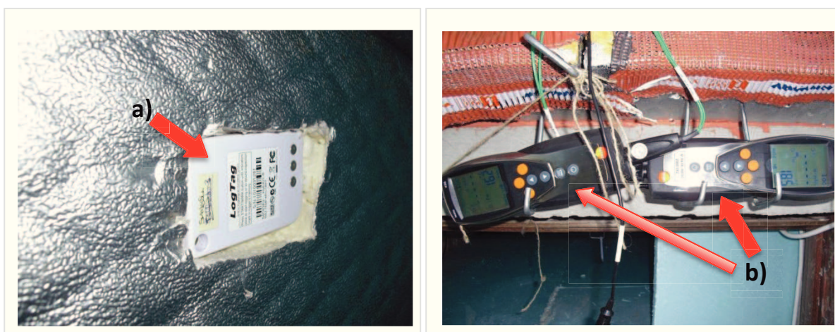
Figura 3.20- Instalação da instrumentação: a) registrador LogTag na placa Naturtherm, b) instrumentos de medição multifunções, Testo 435.
