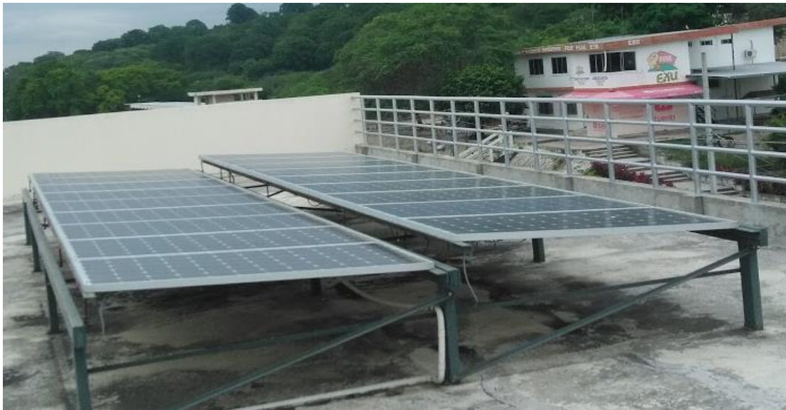
Figura 37 - Micro central fotovoltaica del edificio docente N° 3 38 .
