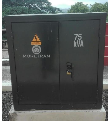
Figura 36 - Transformador de 75kVA tipo padmounted 37 .
