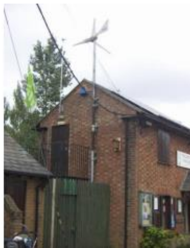
Figura 2 - Turbina Eólica tipo HAWT instalada en el medio urbano
