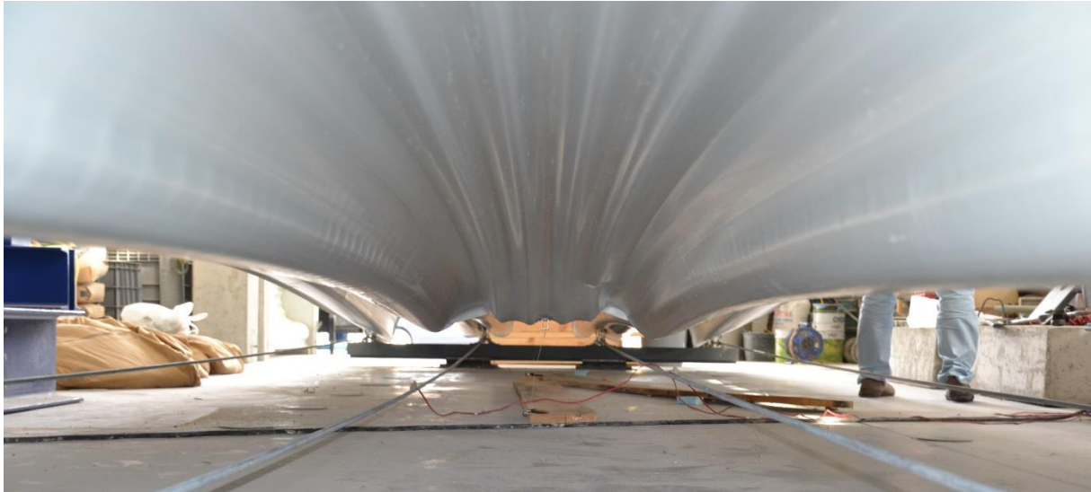
Figura 77 – Colapso da telha central (Vista inferior)
