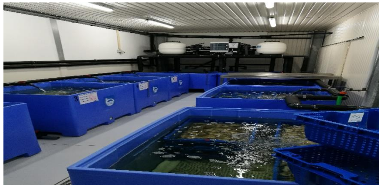
Figura 25 - Depuradora da entidade (imagens do próprio)
