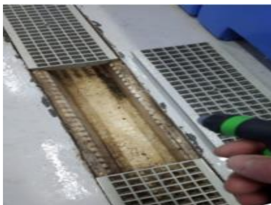
Figura 97 - Limpeza e higienização da vala de escoamento da depuradora (imagens do próprio)
