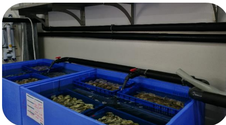
Figura 81 - Tanques de depuração da entidade (imagens do próprio)
