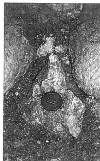
Fig. 38. Estado do cimento, degradado pela acção da planta.
