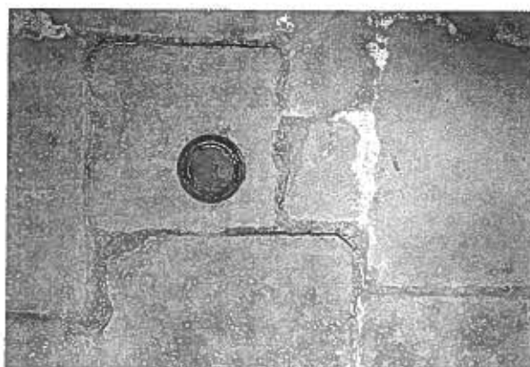
Fig. 40. Pormenor do levantamento 17T após a limpeza – note-se a ausência de cimento em muitos locais, degradado pela acção das plantas.
